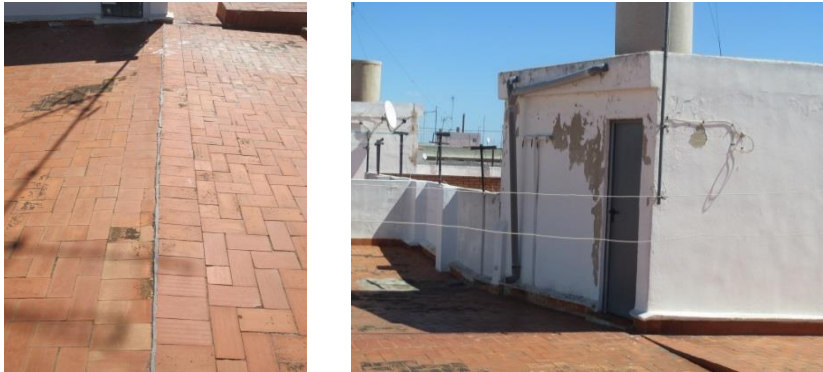
Figura 95. Vistas de zonas puntuales de la cubierta en las que se observa deterioro de los revestimientos, pavimento roto y juntas de dilatación obsoletas por falta de mantenimiento. 2014. Fuente: Autor.
