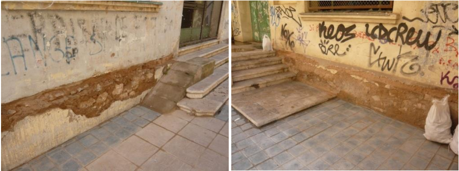
Fig. 41 Deterioro de los zócalos del edificio con pérdida de material y fachadas con grafitis. 2010. www.elpuertoexiste.es
