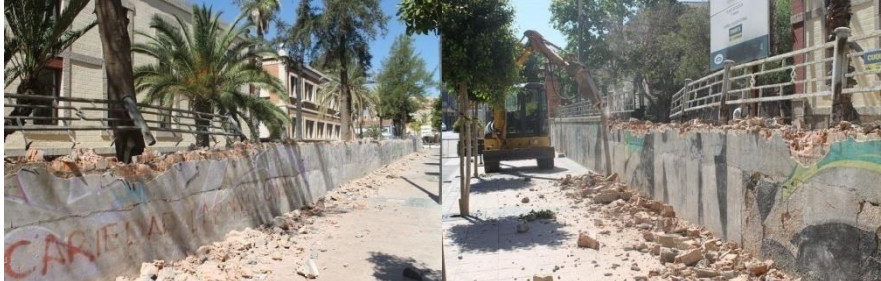
Fig. 79 Derribo de la parte superior del muro y de la antigua valla. 2013. "El Económico"
