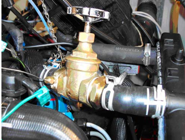
Figura 5.12. Instalación de la válvula mecánica en el ramal de bypass del sistema de refrigeración.
