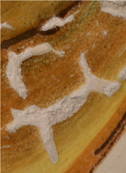
Fig. 29. Con la fotografía de detalle se observa el revestimiento cerámico debido a la contracción del esmalte.
