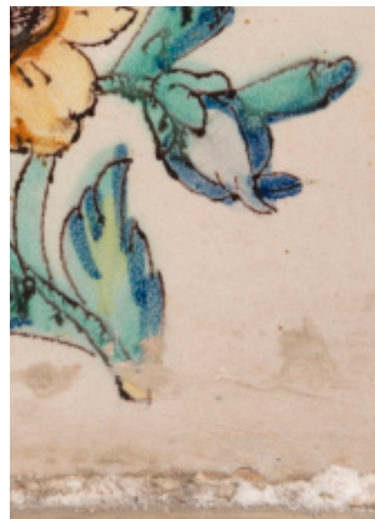
Fig. 42. Depósitos de cemento y sales solubles en la parte inferior del panel.
