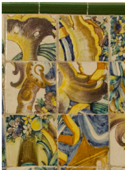
Fig. 10. Elementos que podrían conformar una rocalla ornamental. Debido al desorden de los azulejos, no se ha podido clasificar el tipo de ornamentación.
