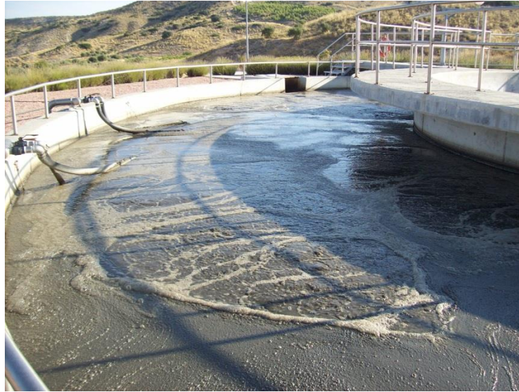
Imagen 13: Canal de oxidación. Se observan la salida al decantador y las conducciones de aire.
