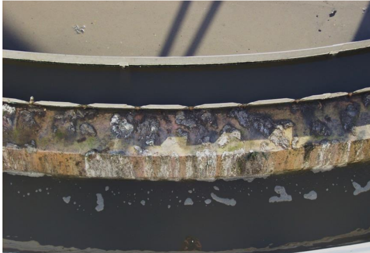
Imagen 17: Detalle del vertedero del decantador secundario. Se observa la elevada turbidez del efluente.
