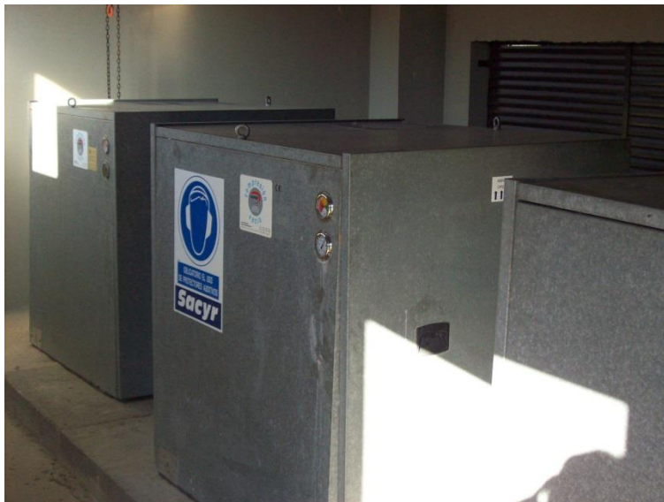
Imagen 15: Vista de las tres soplantes en el interior de las cajas metálicas protectoras.
