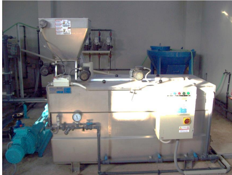
Imagen 9: Equipo de preparación del polielectrolito y bombas dosificadoras (fondo).
