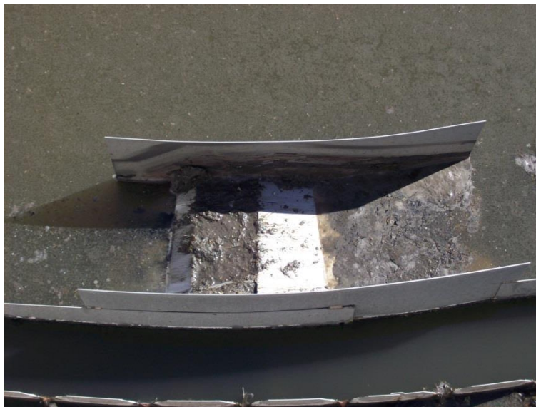
Imagen 18: Flotantes rebosando por la tolva de recogida.
