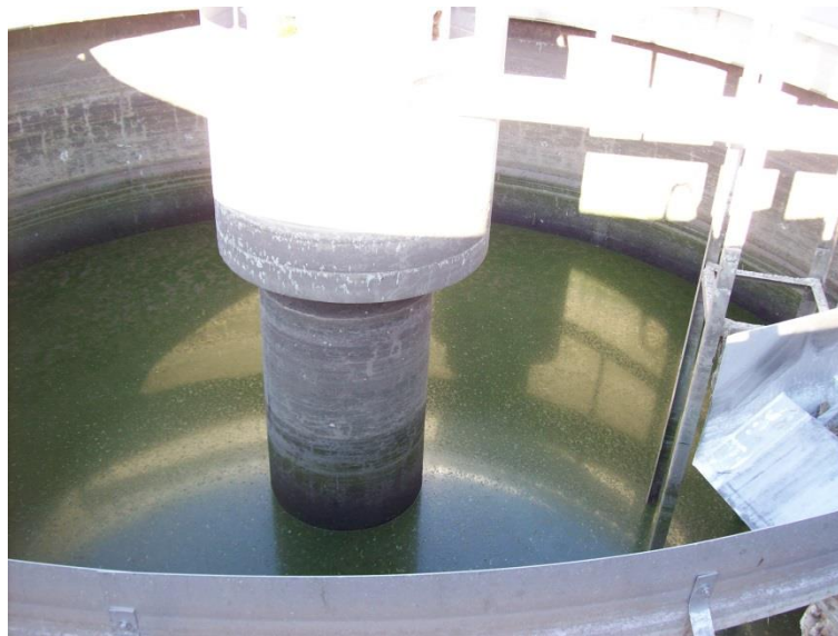
Imagen 10: Decantador primario. Se observa el agua acumulada en su interior.
