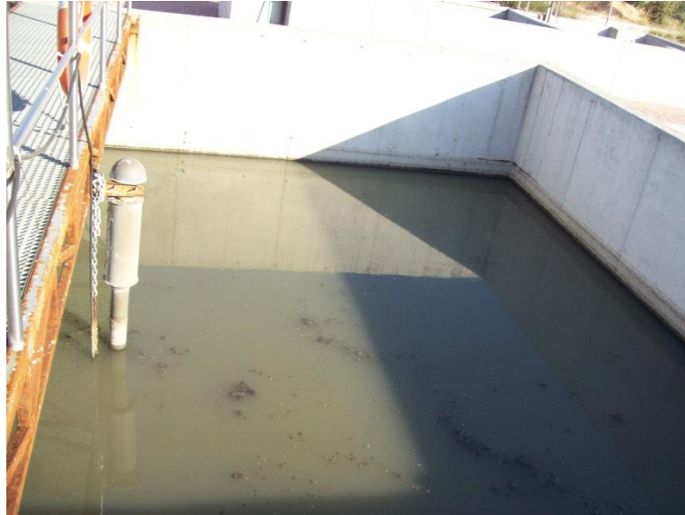
Imagen 6: Balsa de homogeneización. Se observa el agitador parado y suciedad flotando en el agua.
