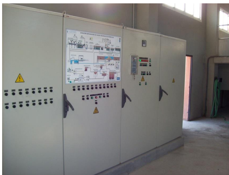
Imagen 22: Cuadro eléctrico de la planta, situado en el interior del edificio de desbaste.
