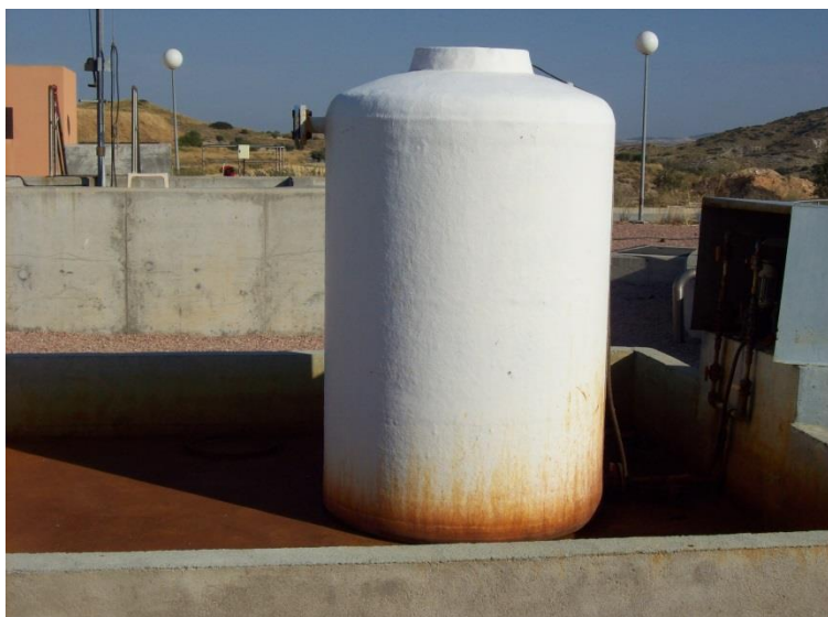
Imagen 8: Tanque de almacenamiento del cloruro férrico y bombas de dosificación (derecha).
