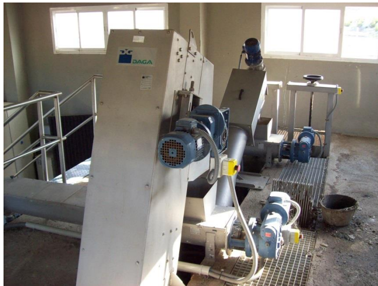
Imagen 3: Canal principal de desbaste (izquierda) y canal de by-pass (derecha).
