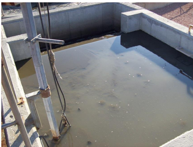
Imagen 12: Balsa anaerobia "selector" y zona de vertido dirección al canal de oxidación.
