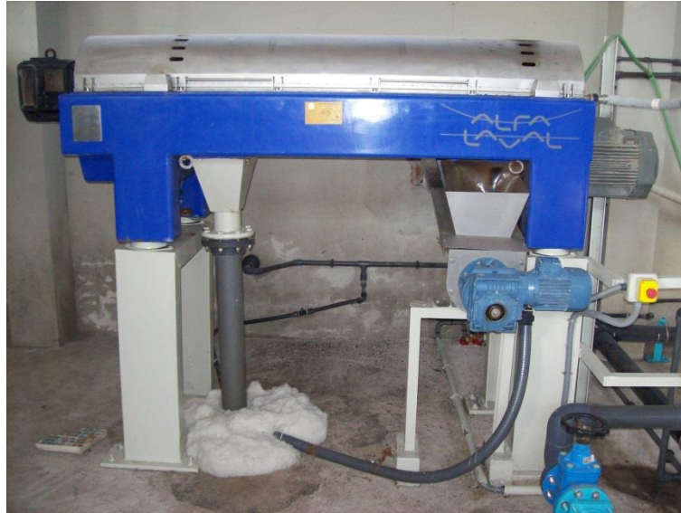
Imagen 20: Máquina centrífuga para la deshidratación del fango espesado.
