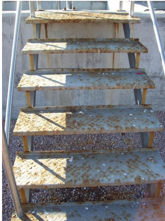
Imagen 23: Escalera metálica cubierta de óxido a causa de un mantenimiento deficiente.
