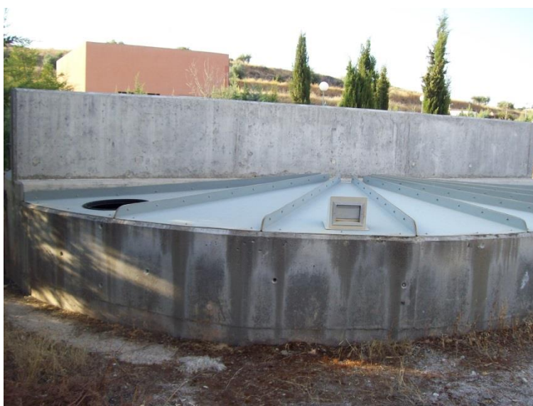
Imagen 19: Espesador de fangos enterrado y con cubierta.
