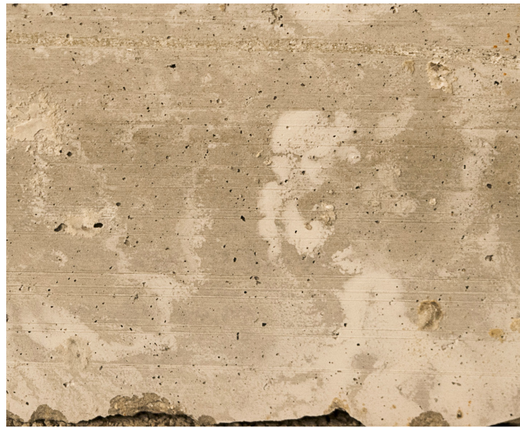
Fig. 32 Manchas de infiltraciones en una viga de hormigón que forman imágenes reconocibles (foto propia).
