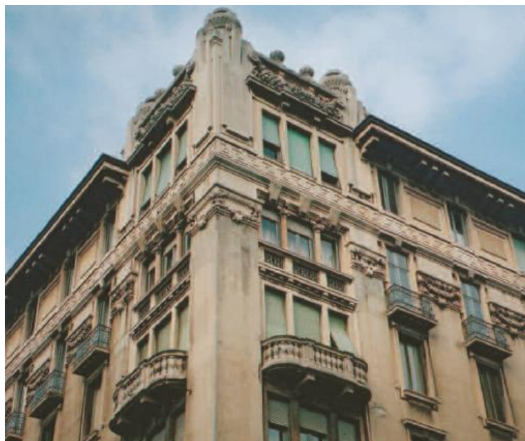
Esempio di facciata con una forte presenza di cementi decorativi. Immagine dalla rivista SPECIALIZZATA 140 • Dicembre/Gennaio 2005 -Pietra artificiale: il recupero dei cementi decorativi. Rebeca Fant
