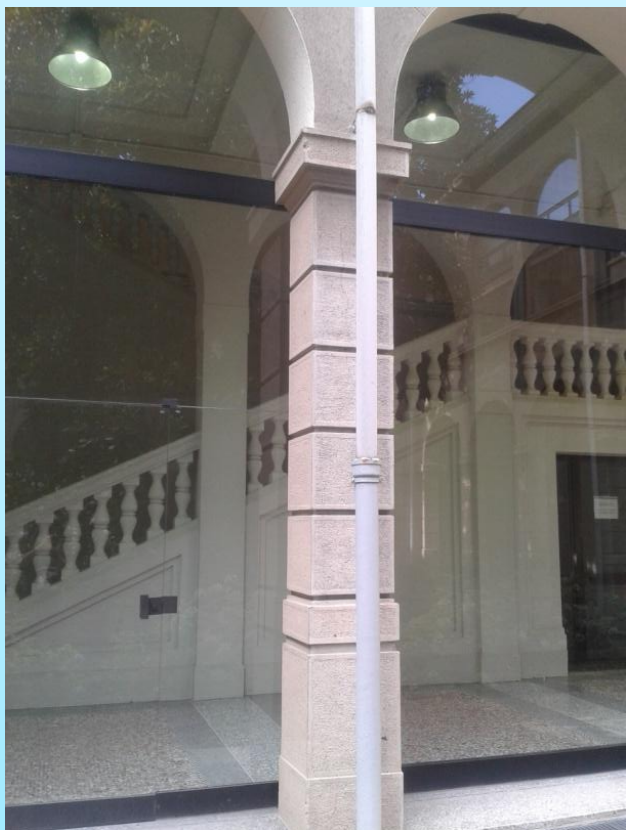
Immagine Propia. Canaline e cornicine 2.
