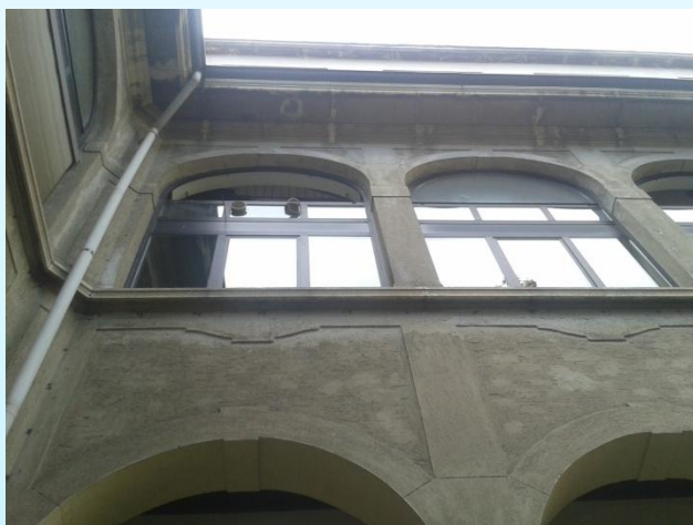
Immagine Propia. Canaline e cornicine 1.
