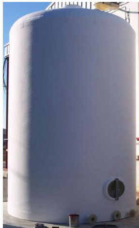
Figura 13: Depósito de abastecimiento de agua de 12\ m^3 de capacidad. Fuente: Perfipresa.
