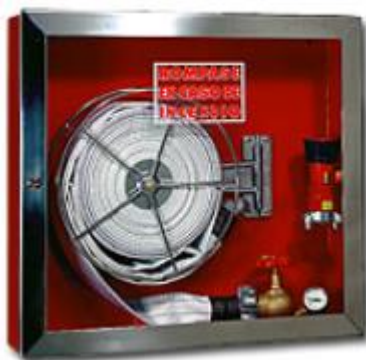
Figura 9: Boca de incendio equipada (BIE) de 45 mm. Fuente: Todogoma.
