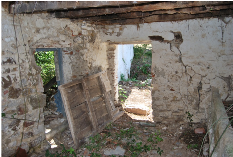
Figura 21. Estado del pavimento interior. (Fuente propia)
