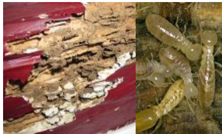
Fig. 33. Pudrición por termitas.
