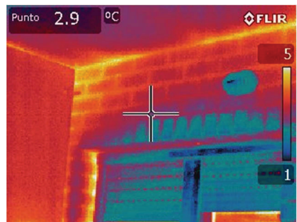
Imagen 30. Puente térmico en balcón
