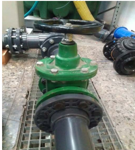
Figura 4.12. Válvula de regulación del caudal.
