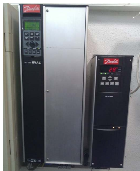
Figura 4.11. Variador de Frecuencia.
