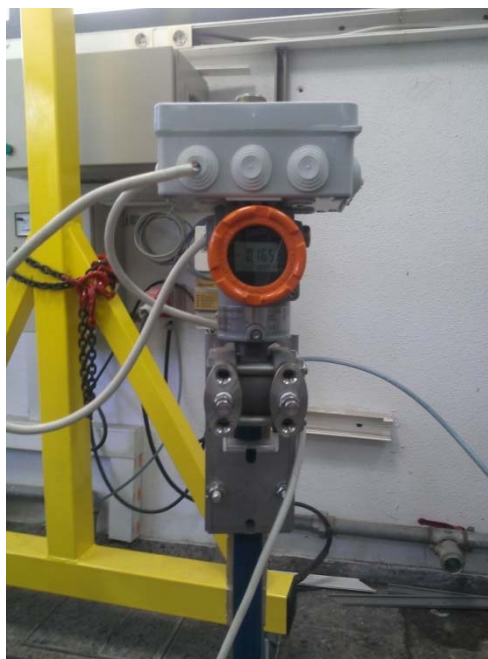
Figura 4.16. Transductor de presión diferencial.
