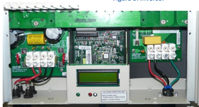
Figura 4: Vista del display y la electrónica del inversor
