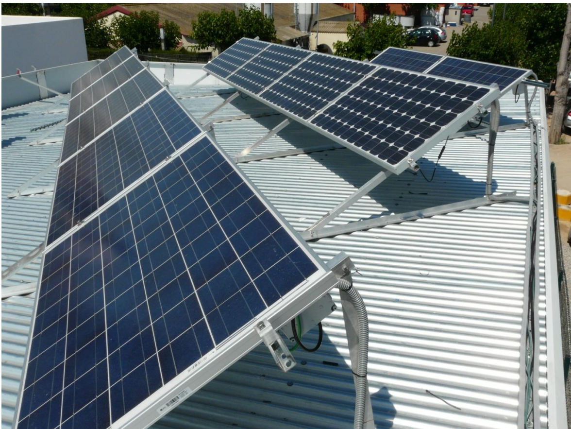
Figura 1: Paneles solares del LABDER
