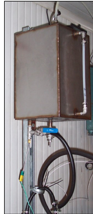
Imagen 3.8 Línea de combustible
