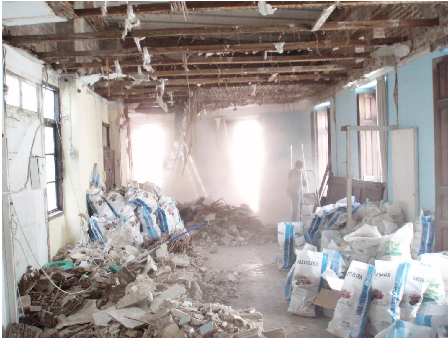
Acumulación de escombros
