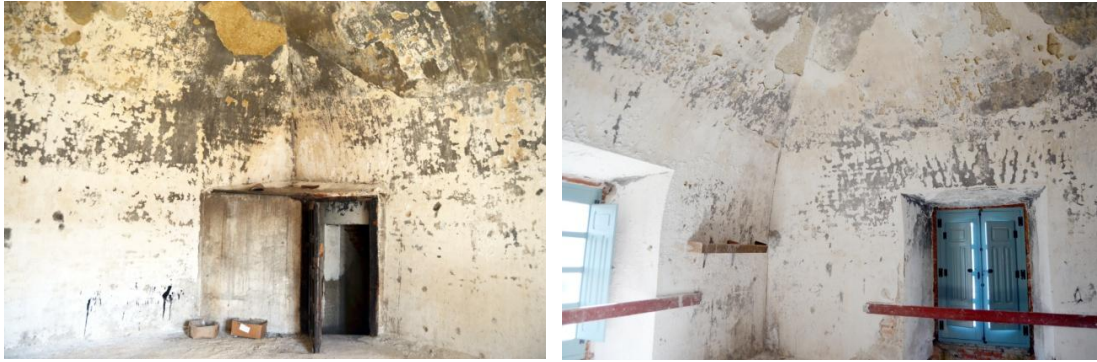
Ilustración 36. Humedades en los torreones de la boardilla.
