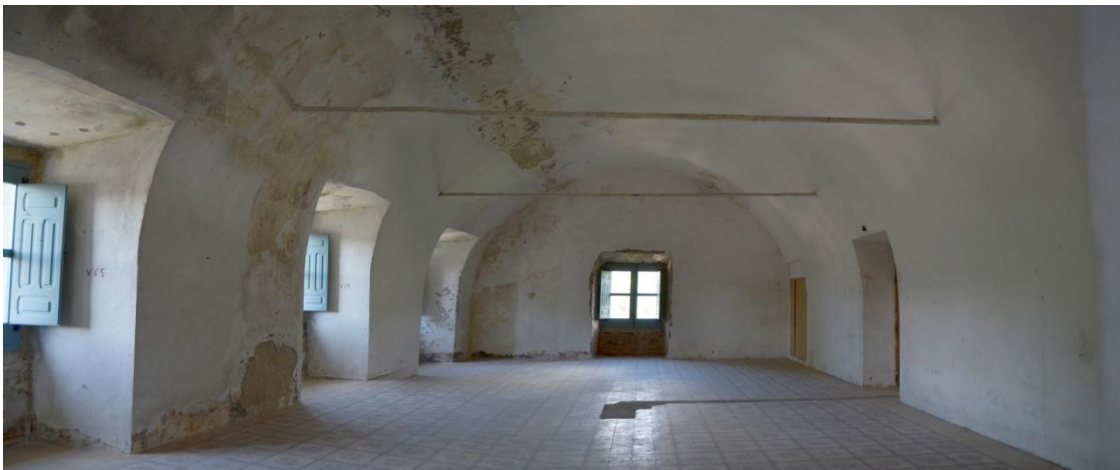
Ilustración 35. Humedades en las estancias de la segunda planta.
