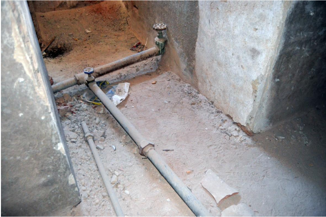
Ilustración 30. Tubos de fontanería descubiertos. Boardilla.
