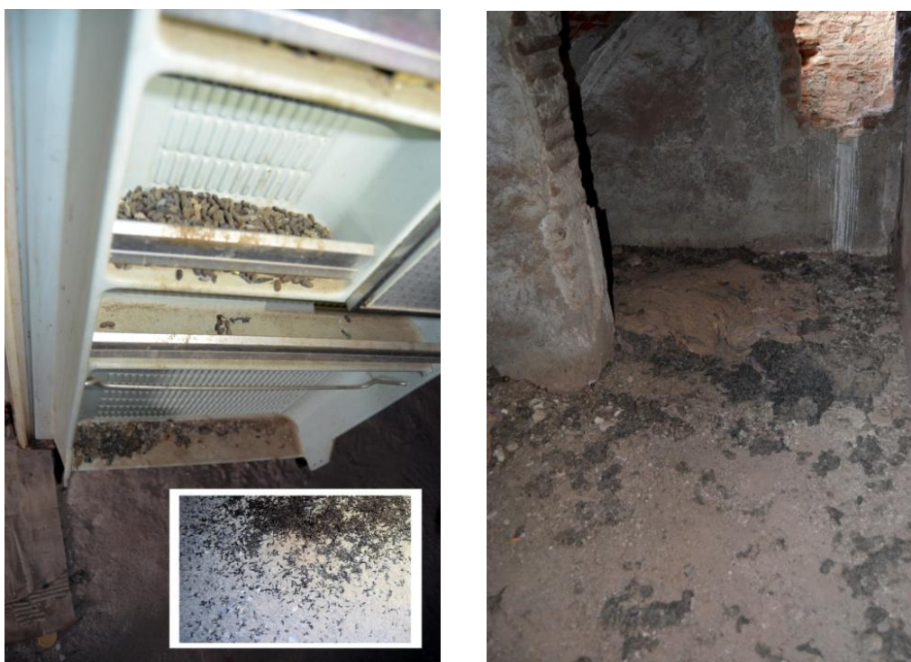
Ilustración 29. Detalle de presencia de insectos y roedores y orificios abiertos. Boardilla.
