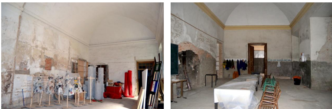
Ilustración 38. Humedades en las estancias de la planta baja.
