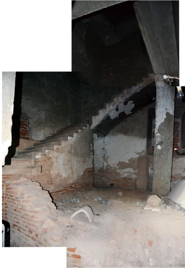
Ilustración 34. Estado de la escalera interior del ala izquierda.
