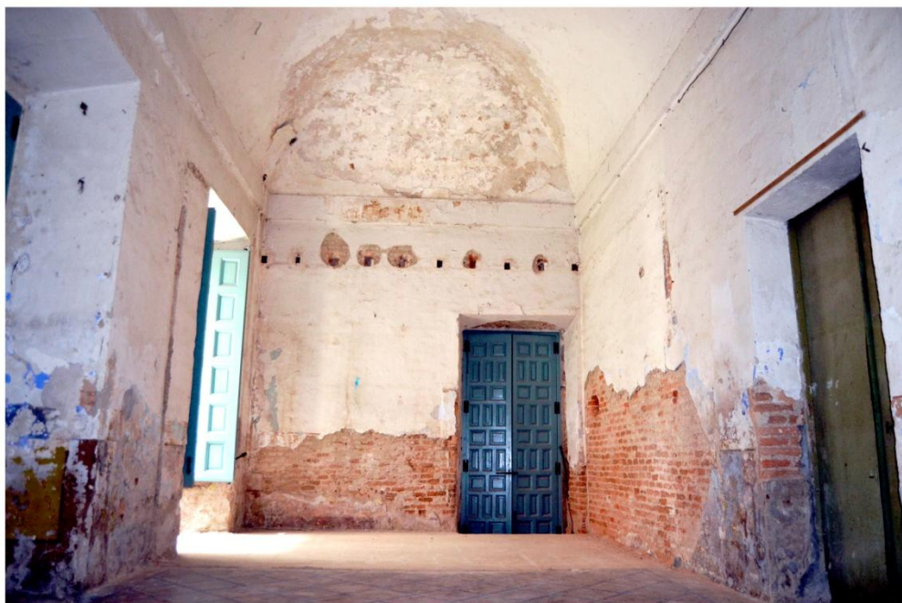
Ilustración 37. Humedades en las estancias colindantes a los jardines en la planta baja.
