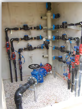
Figura 3. Hidrante instalado en la CCRR L'Alcúdia.
