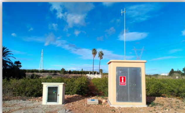
Figura 11. Boca de incendio y surtidor de toma.
