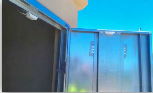
Figura 4. Sensor de intrusión y refuerzo con perfiles en puerta de hidrante.
