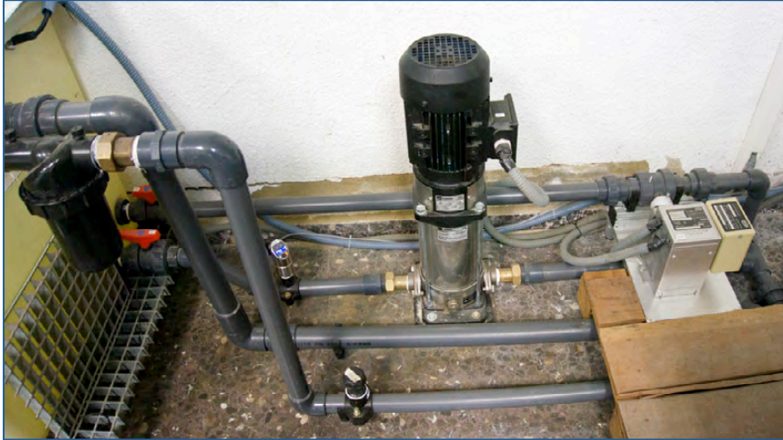
Fotografía 1: Grupo de presión, bypass con válvula motorizada y sensor de temperatura.
