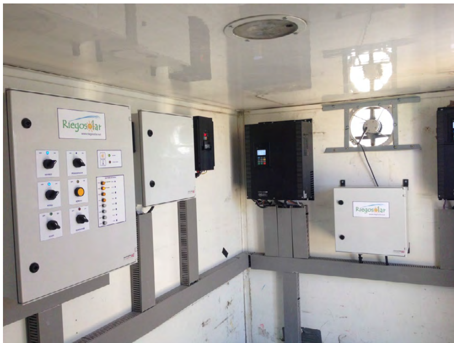
Figura 2: Cuadros de control y variadores de frecuencia
