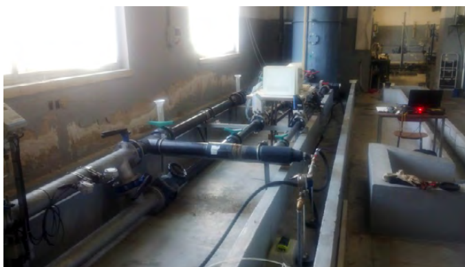
Imagen 2. Banco de ensayos para ramales.
