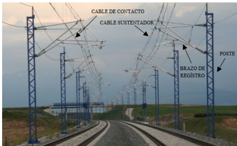
Figura 1.2: Imagen de una catenaria tipo AVE.
