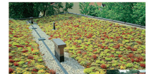
Cubierta ecologica de la casa Zinco. Extensiva Tipo Sedum Tapizante
