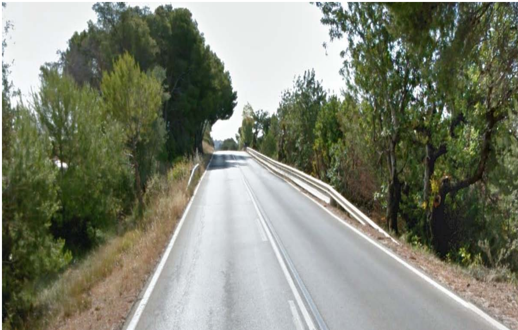
Ilustración 52: Altura de Barrera Insuficiente (Fuente: Elaboración Propia)
