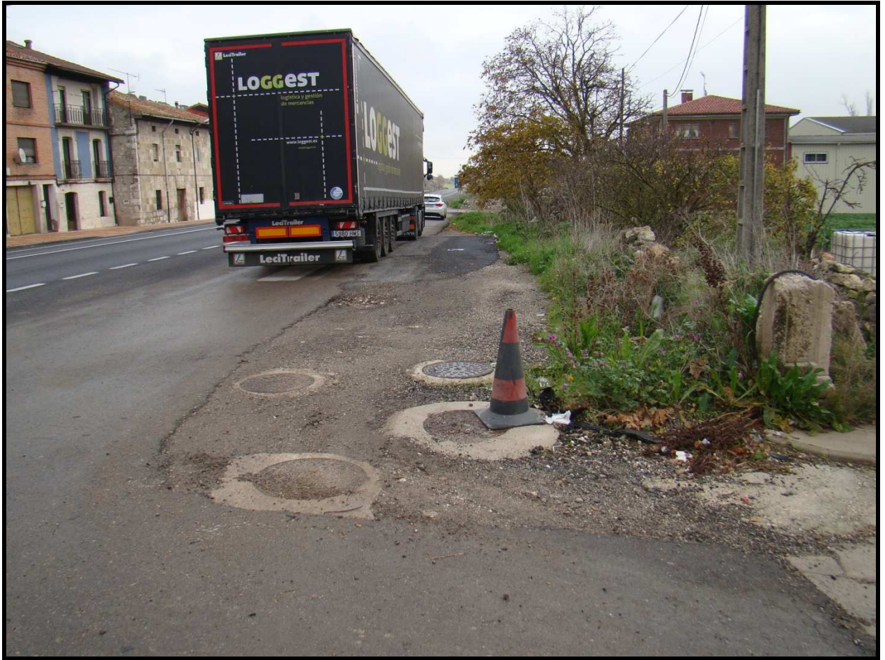
Ilustración 80 Estado de los márgenes de la carretera
