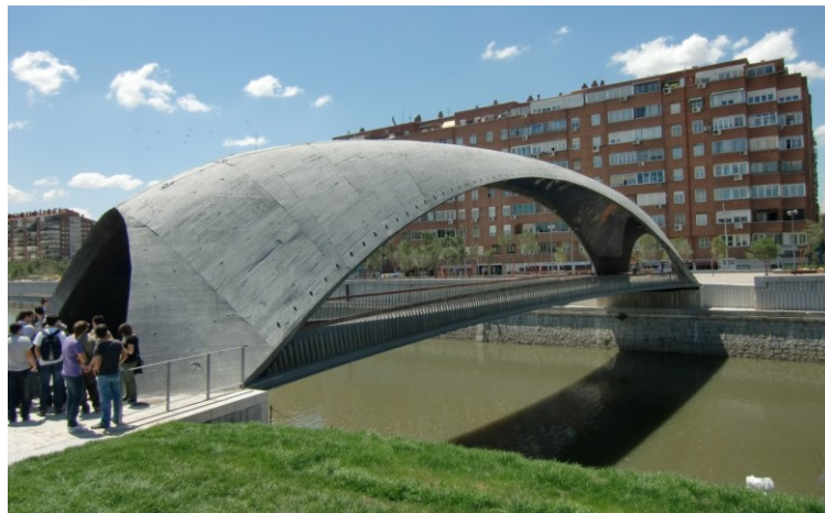
Fig. 7. Pasarela Cáscara en el proyecto Madrid Río, Madrid (2010). Arquitectura: Equipo Madrid Río, ingeniería: Fhecor Ingenieros Consultores. Imagen: I. Payá Zaforteza.
