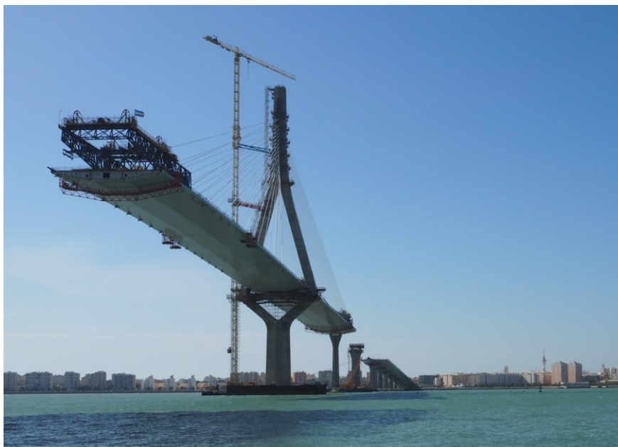
Fig. 8. Fotografía del nuevo puente sobre la Bahía de Cádiz tomada durante su construcción. Imagen: I. Payá Zaforteza.
