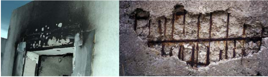
Figura 14 Resultados del efecto spalling [11]
