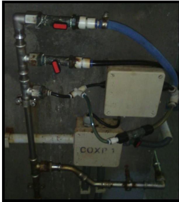
Fig. 24: Detalle de la instalación para la entrada de oxígeno
