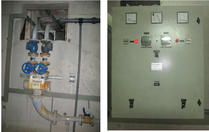
Figura 27. Bombas y variador de frecuencia instalados en el pozo2
