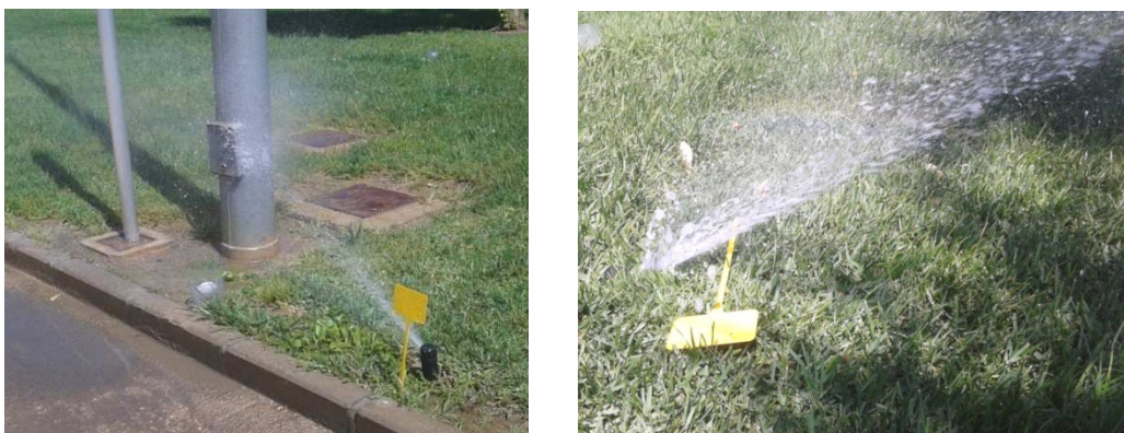
Figura 18. Detalle de intercepción y mal funcionamiento de un aspersor
