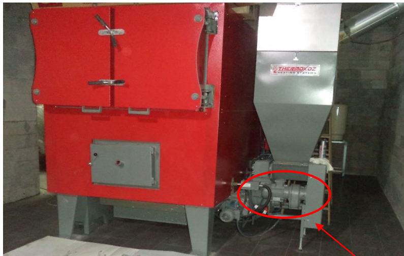
Figura 2: Caldera y sistema alimentación
