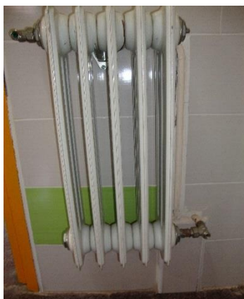
Fig 5.6. Radiador de acero.
