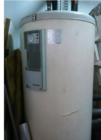
Fig 5.12 .Acumulador de 500 litros.
