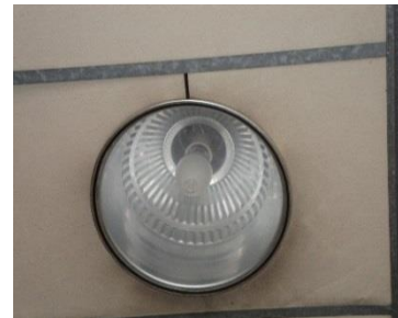
Fig 6.5. Lámpara de vapor de sodio.
