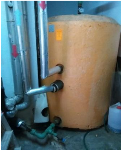
Fig 5.11. Acumulador de 1500 litros.
