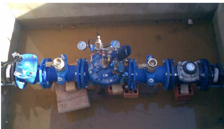
Figura 8: vista de la conexión general a la red del EMSHI.
