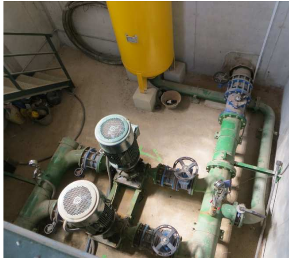
Figura 16: vista superior del grupo de impulsión
