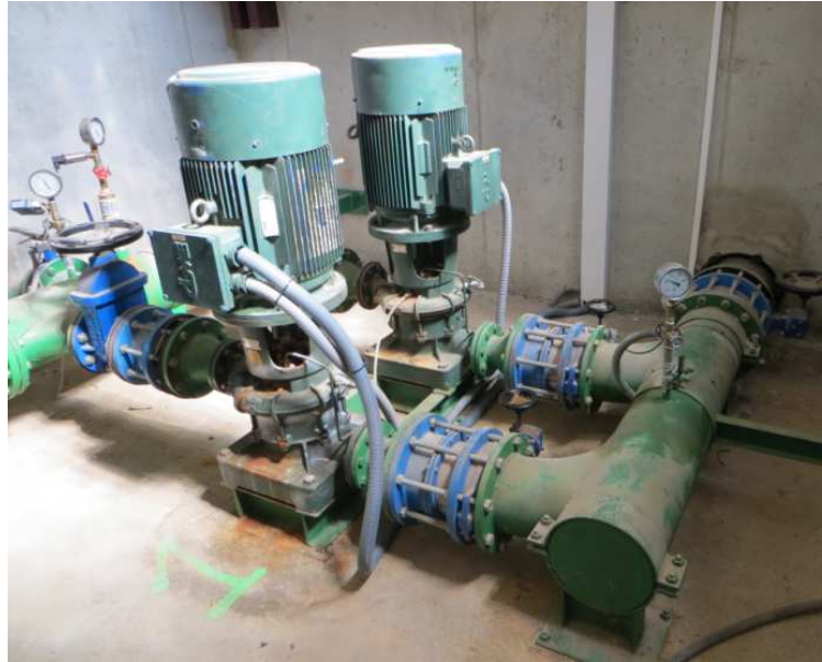
Figura14: grupo de impulsión a la urbanización Monasterios.
