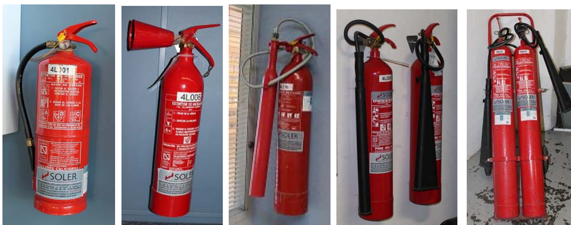
Imagen 38: Distintos tipos de extintores
