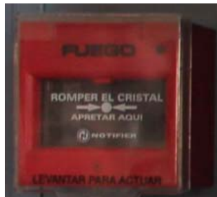
Imagen 33: Pulsador de alarma
