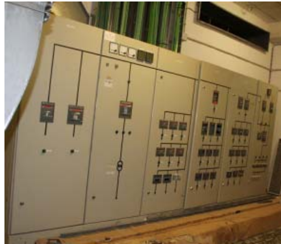
Imagen 27: Cuadro General de Protección
