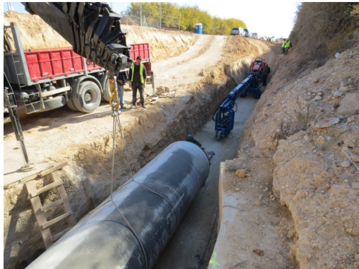
Ilustración 28. Tubería y útil de carga
