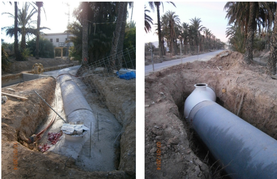
Ilustración 27. Fotografías tubería instalada en by-pass de galería
