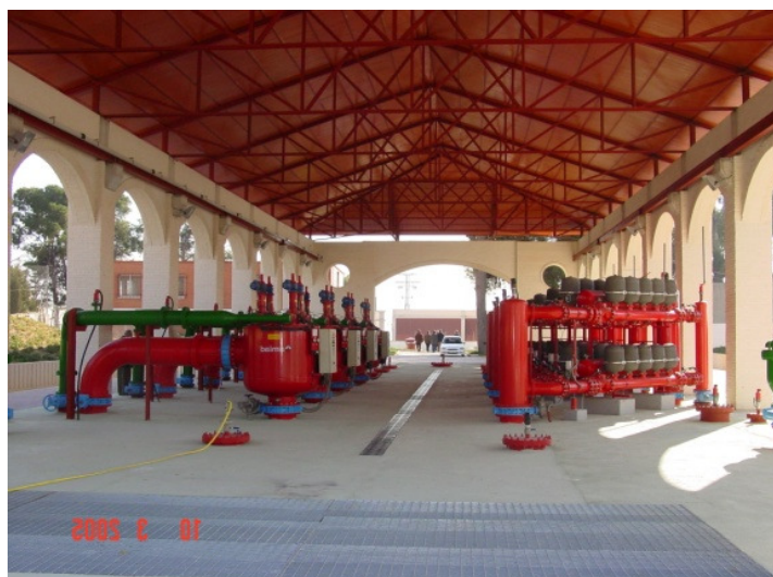
Ilustración 19. Vista general de la estación de filtrado de la Quinta Elevación
