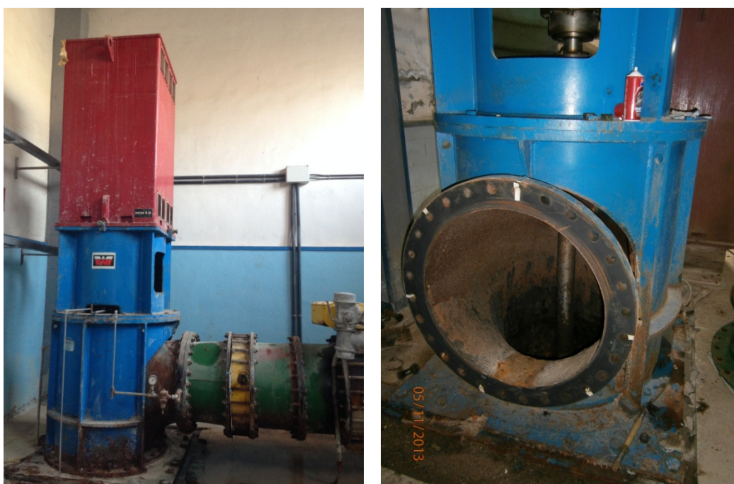
Ilustración 7. Bombas verticales instaladas a principios de los años 80
