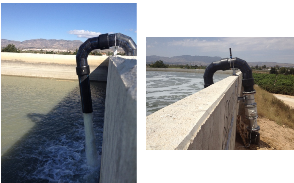
Ilustración 15. Llenado desde la red de modernización
