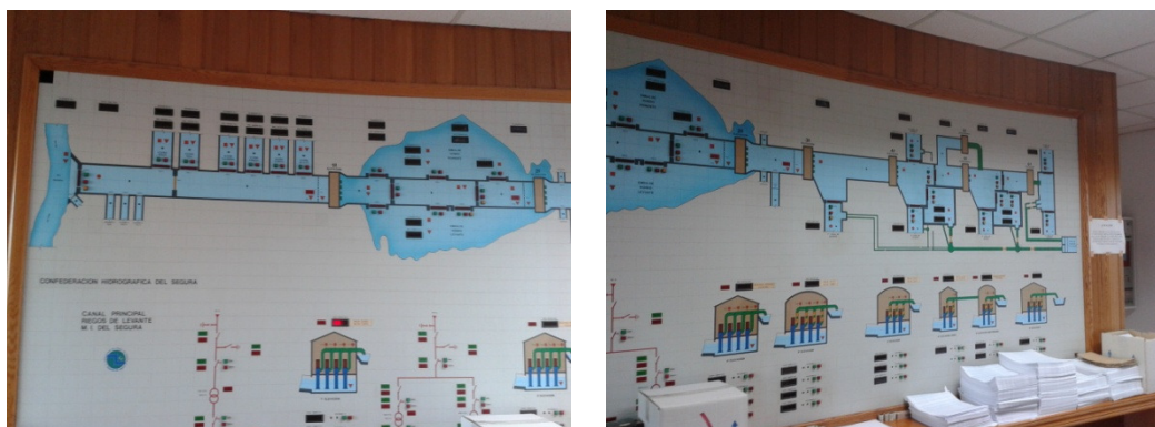
Ilustración 14. Centro de telemando
