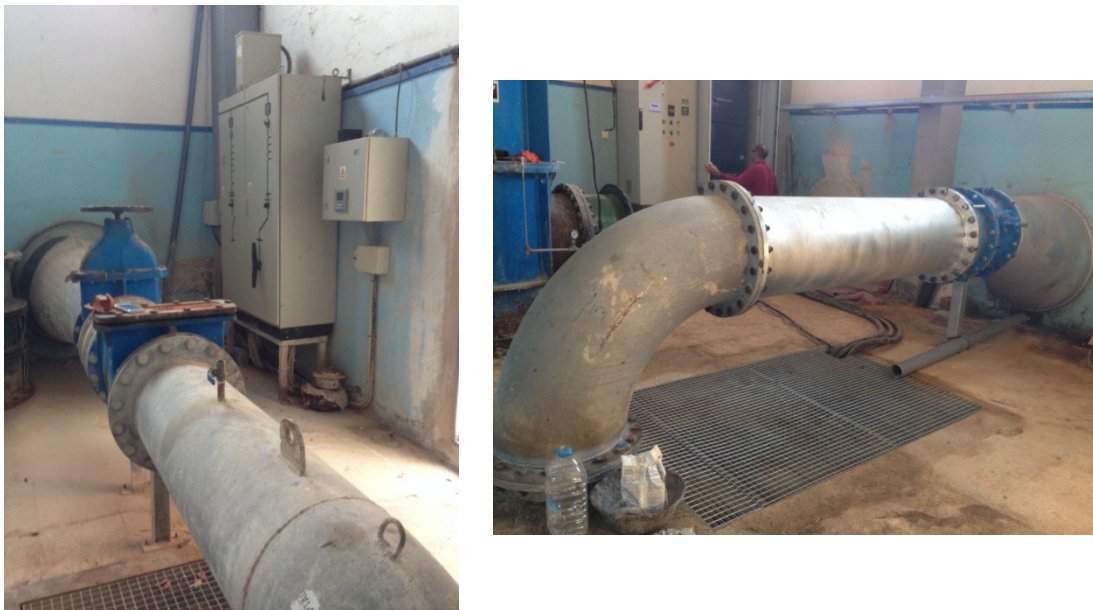
Ilustración 12. Colectores de impulsión a la salida de las bombas actuales.
