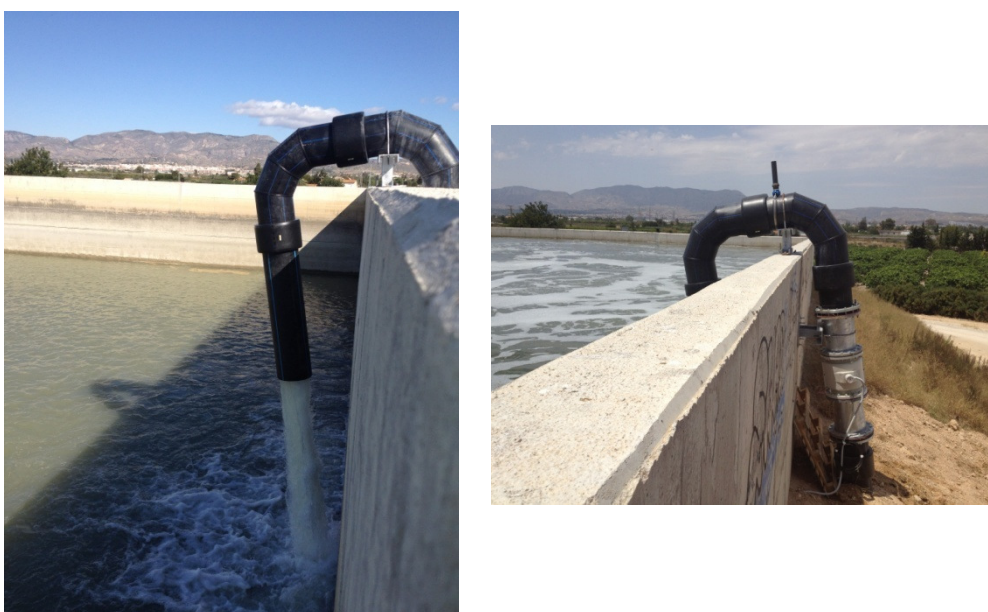
Ilustración 15. Llenado desde la red de modernización
