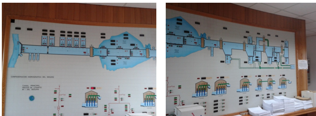
Ilustración 14. Centro de telemando
