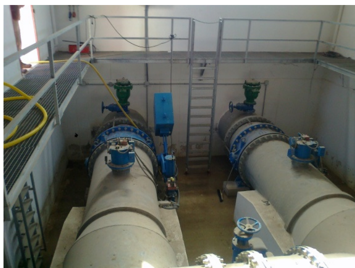
Ilustración 18. Vista del interior de la arqueta con válvulas de sobrevelocidad
