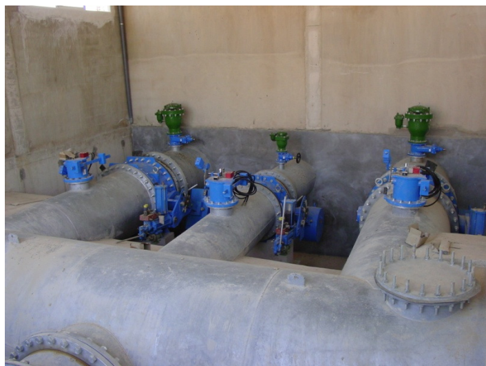
Ilustración 20. Colectores de derivación y valvulería se seccionamiento
