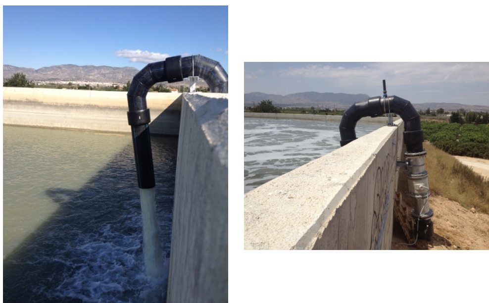
Ilustración 15. Llenado desde la red de modernización
