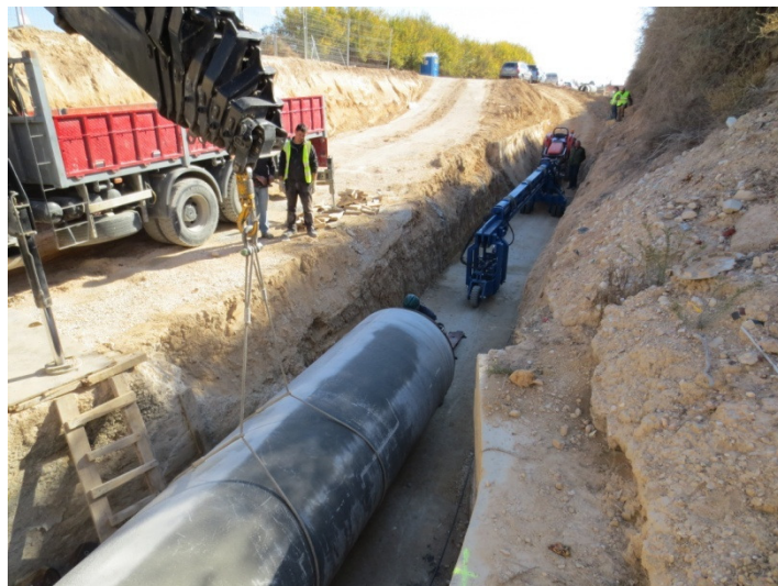
Ilustración 28. Tubería y útil de carga
