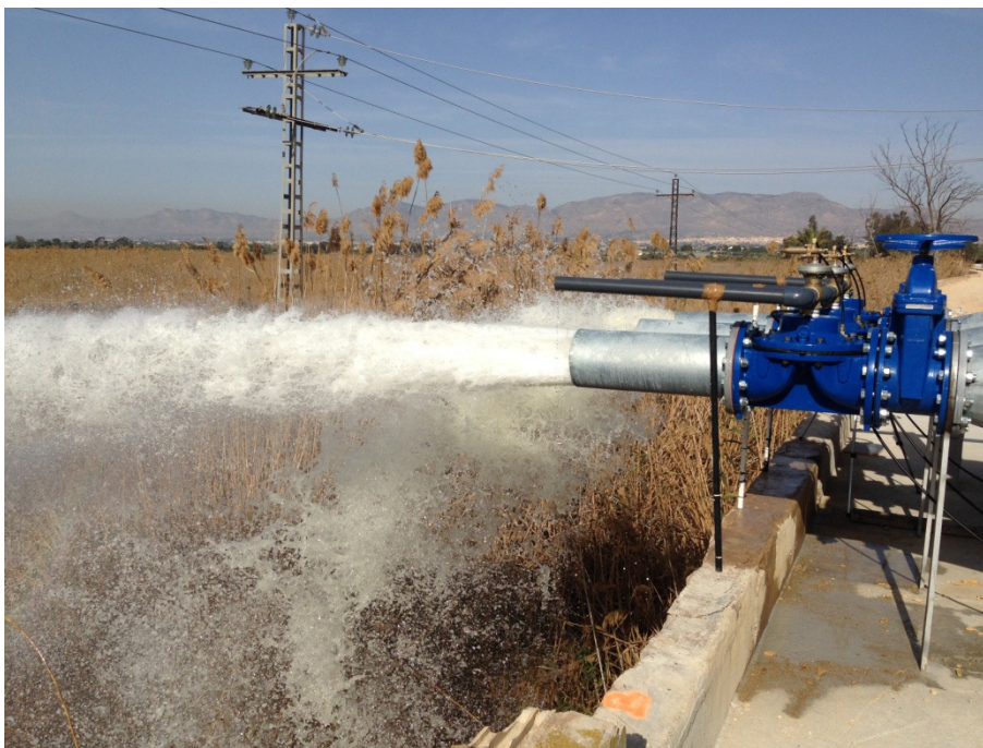
Ilustración 33. Vista del sistema de protección con válvulas anticipadoras de onda y ventosas
