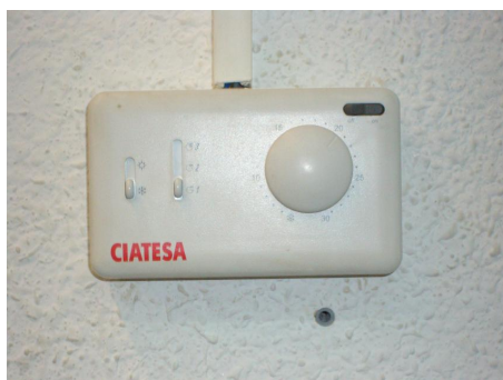
Figura 3.8: Panel de control de los fancoils
