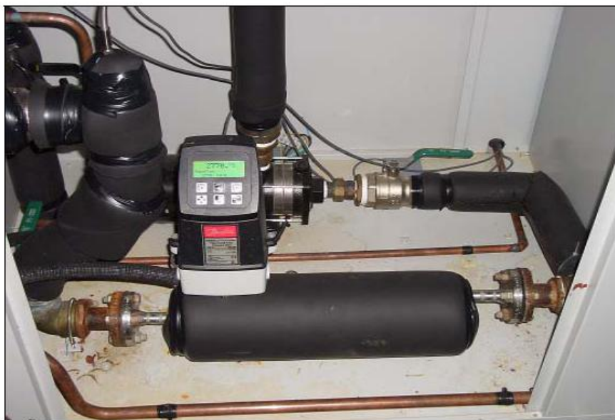
Figura 3.21: Caudalímetro instalado en el circuito externo
