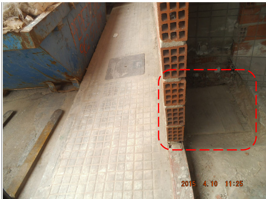
Imagen nº 2: Arqueta de saneamiento en interior de vivienda
