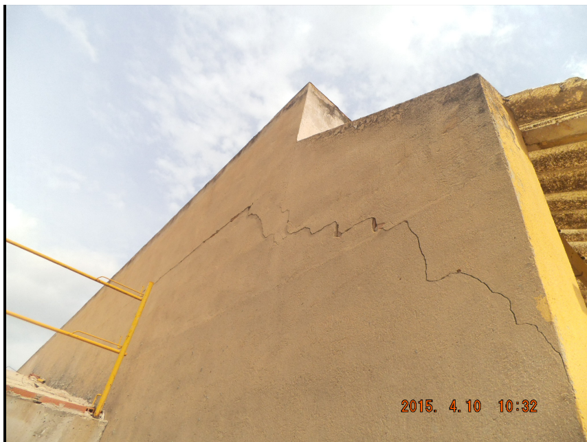
Imagen nº 5: Grieta en medianera de edificio colindante
