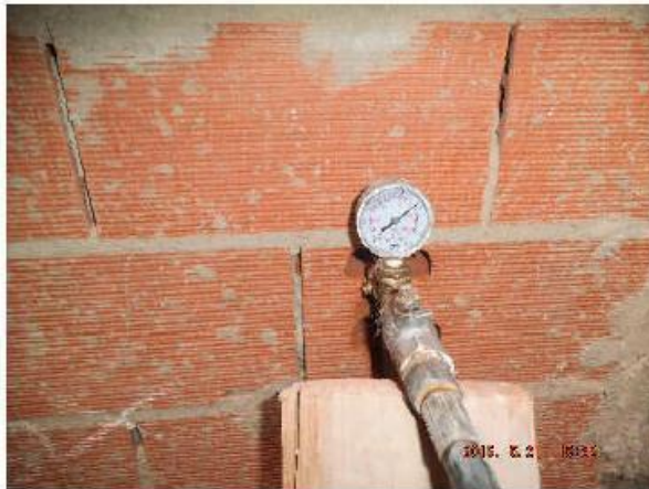
IMAGEN 2. Revisión de las pruebas de carga de las instalaciones de ACS Y AF.
