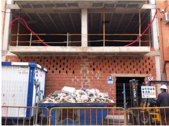
FOTO1: fachada principal de la obra. algunas medidas de seguridad colocadas. contenedor con los escombros recogidos.
