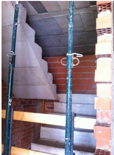
FOTO2: escalera mal ejecutada.
