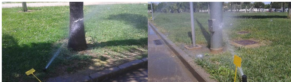
Figura 18: Detalle de la intercepción del chorro de agua con un árbol y una farola en parcela Pradera Central.
