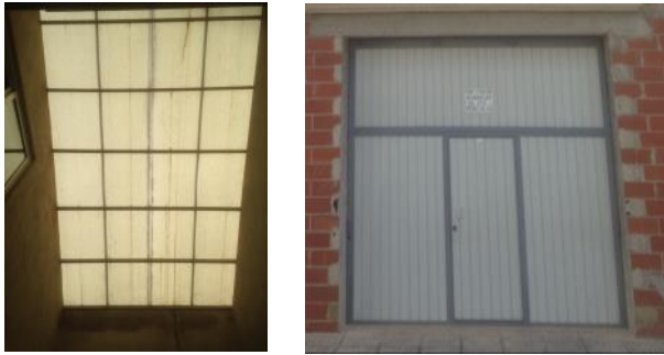
Figura 48: Lucernario y puerta garaje. Año 2015. Fuente propia.
