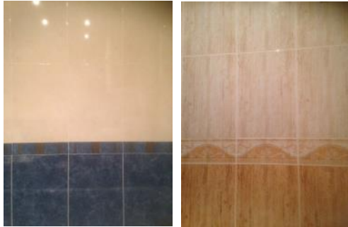
Figura 45: Alicatado cuarto de baño y cuarto de aseo. Año 2015. Fuente propia.
