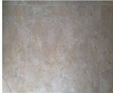
Figura 41: Gres pasillo y resto vivienda. Año 2015. Fuente propia
