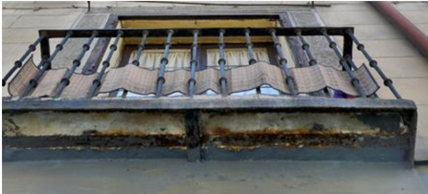
Ilustración 52. Humedad por filtración.
