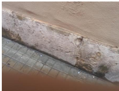
Ilustración 72. Erosión del zócalo de edificio de estudio. Abril 2015.
