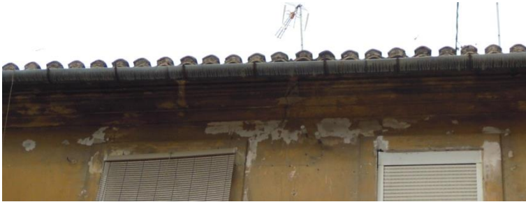
Ilustración 26. Desprendimiento de pintura bajo cornisa. 2015.
