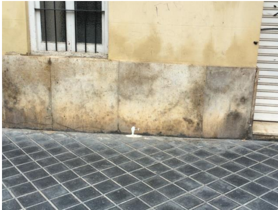
Ilustración 50. Humedad por capilaridad.
