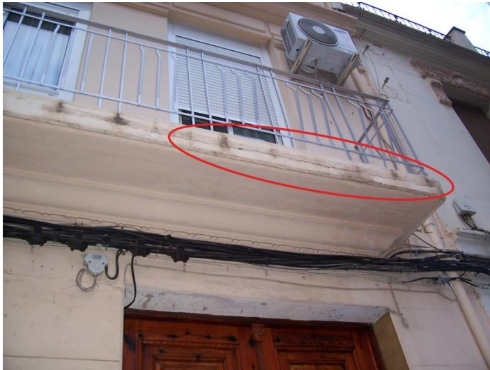
Ilustración 60. Fisura en balcón. Abril 2015.
