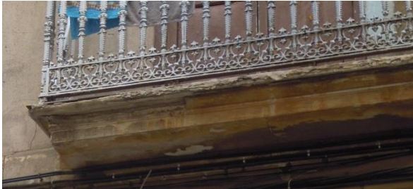
Ilustración 24. Pérdida de sección en molduras. 2015.
