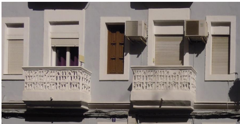
Ilustración 41. Balcón revestido con un punto de desagüe en edificio de estudio. Abril 2015.
