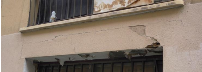
Ilustración 21. Grietas en dinteles. 2015.
