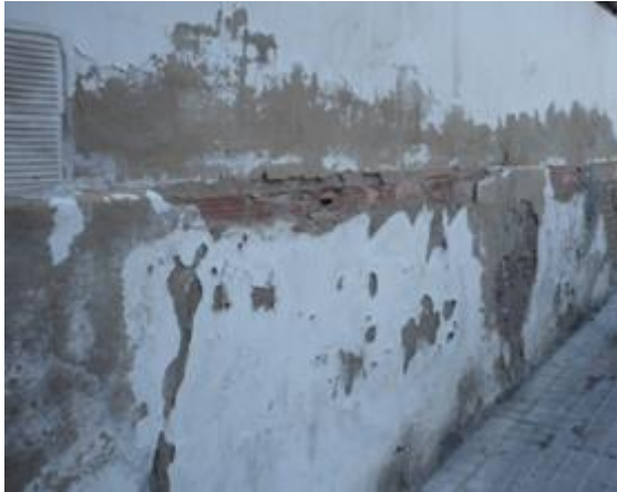
Ilustración 49. Humedad por capilaridad. Abril 2015.
