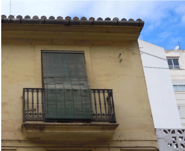
Ilustración 43. Ejemplo de anclaje como elemento impropio en edificio de estudio. Abril 2015.
