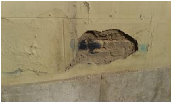
Ilustración 62. Desprendimiento acabado continuo. Abril 2015.
