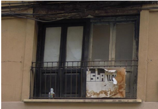
Ilustración 27. Decoloración de la carpintería. 2015.
