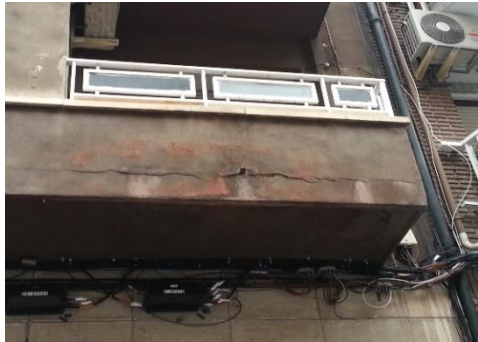
Ilustración 66. Oxidación pieza desagüe provocando una fisura. Abril 2015.
