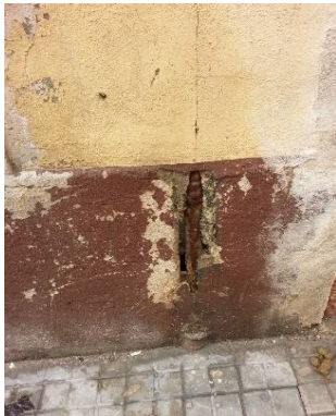
Ilustración 65 .Oxidación de la consiguiente rotura del revestimiento. Abril 2015.
