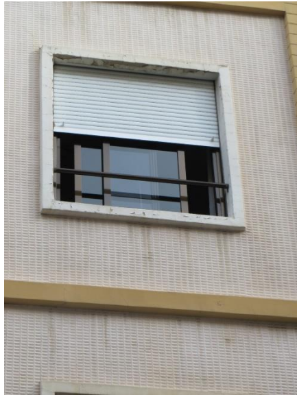
Ilustración 55. Suciedad por lavado diferencial. Abril 2015
