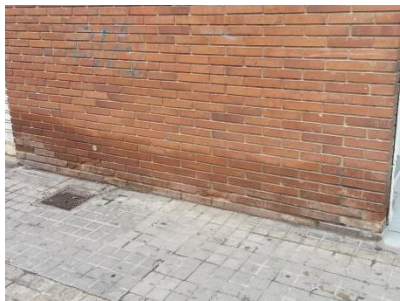
Ilustración 71 .Erosión parte baja de ladrillo cara vista. Abril 2015.
