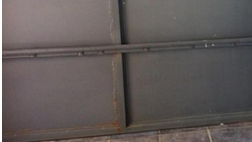
Ilustración 67. Corrosión por aireación diferencial. Abril 2015.
