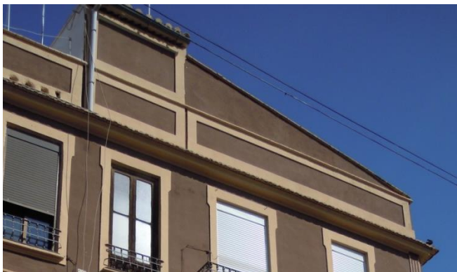
Ilustración 47. Ejemplo de cornisa de coronación en cubierta inclinada en edificio de estudio. Abril 2015.
