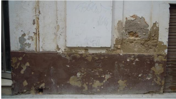
Ilustración 19. Desprendimiento de pintura. 2015.
