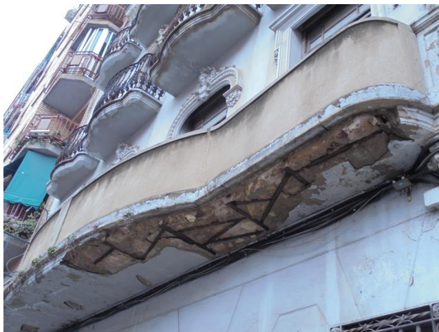
Ilustración 61. Desprendimiento en balcón causado por grietas.
