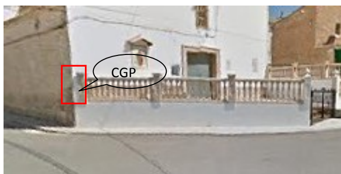
Fotografía 1 Situación de CGP
