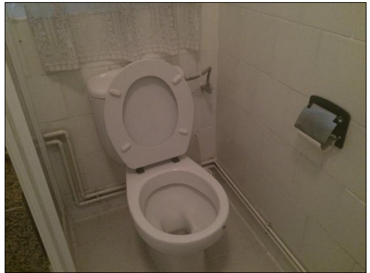
Imagen 29 Instalaciones vistas (2015) Fuente propia
