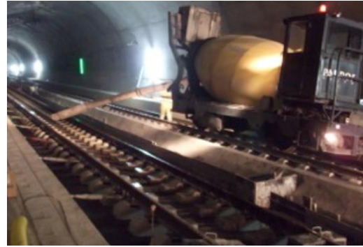
Figura 18. Fotografía del hormigonado de la vía 2 mediante cuba sobre carriles en vía 1.
