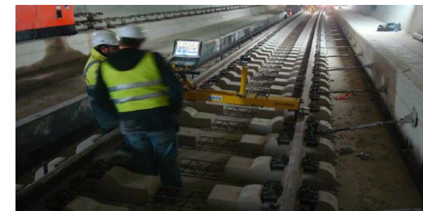
Figura 16. Fotografía del posicionamiento y comprobación geométrica de la vía previa al hormigonado.
