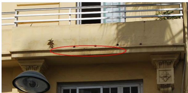
Ilustración 48. Fisura en balcón de C/Visitación, 35. 2015. Fuente propia.
