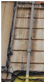
Ilustración 21. Grieta longitudinal vertical. 2015. Fuente propia.
