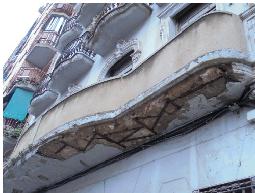
Ilustración 49. Desprendimientos de revestimiento en balcón de Av. Constitución, 66. 2015. Fuente propia.
