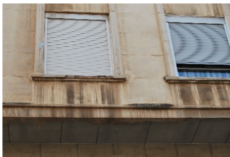
Ilustración 43. Suciedad por lavado diferencial en C/Sagunto, 112. 2015. Fuente propia.
