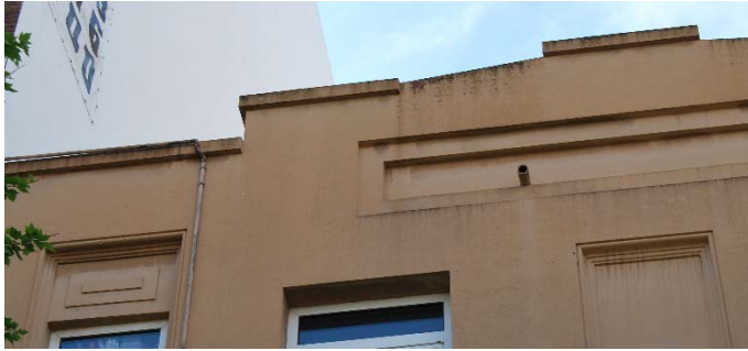
Ilustración 38. Antepecho sin albardilla de coronación en C/Actor Mora, 25. 2015. Fuente propia.
