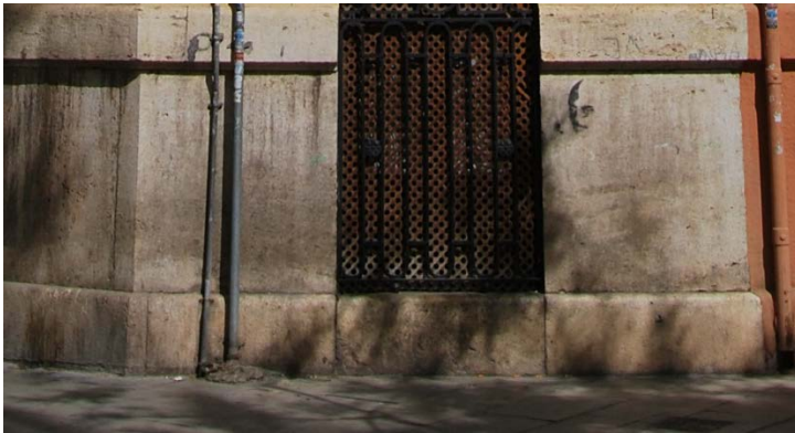
Ilustración 56. Erosión del zócalo de C/Ruaya, 42. 2015. Fuente propia.
