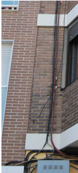
Ilustración 32. Junta de dilatación entre dos edificios objeto de estudio. 2015. Fuente propia.
