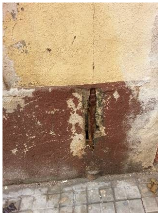
Ilustración 53. Oxidación con el consiguiente desprendimiento del revestimiento en C/Oriola, 33. 2015. Fuente: Guillem Aparicio.
