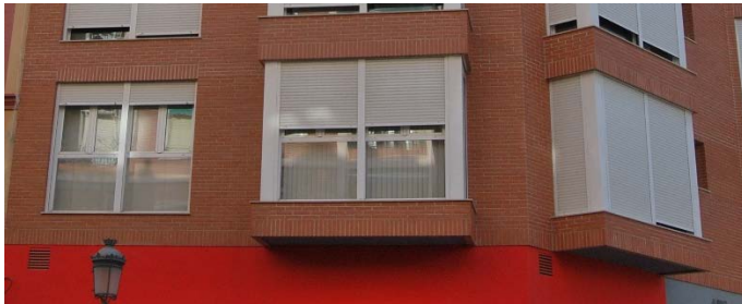
Ilustración 31. Encuentros de la carpintería con la fachada de C/Bilbao, 17. 2015. Fuente propia.
