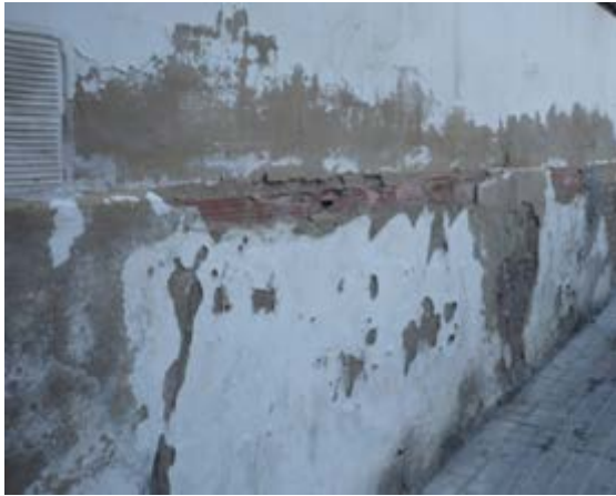
Ilustración 39. Humedad por capilaridad en C/Lleida, 29. 2015. Fuente: Alberto Udaeta.
