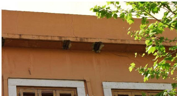
Ilustración 37. Cornisa deteriorada en C/Actor Mora, 27. 2015. Fuente propia.
