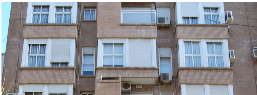
Ilustración 52. Eflorescencias en C/Fray Pedro Vives, 12. 2015. Fuente propia.
