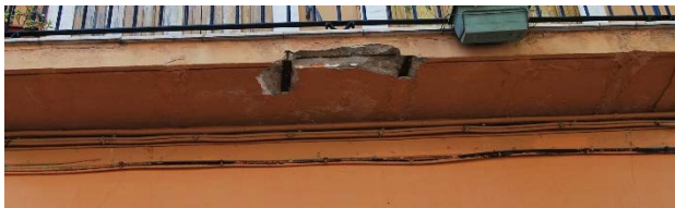
Ilustración 41. Humedad bajo voladizo en C/Actor Mora, 27. 2015. Fuente propia.
