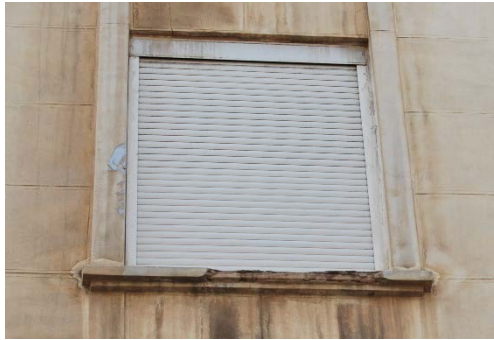
Ilustración 24. Rotura de vierteaguas. 2015. Fuente propia.
