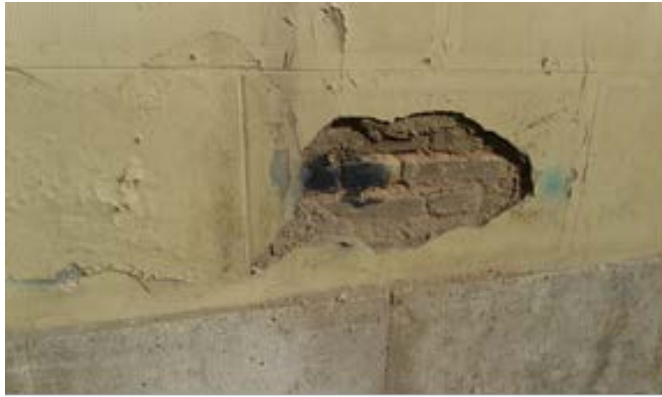
Ilustración 50. Desprendimiento de acabado continuo en C/Visitación, 25. 2015. Fuente: Francisco Delás.
