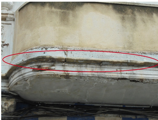
Ilustración 44. Erosión atmosférica en Av. Constitución, 66. 2015. Fuente: Luis Navarro.
