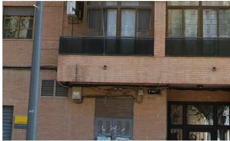
Ilustración 40. Humedad accidental en C/Actor Mora, 31. 2015. Fuente propia.
