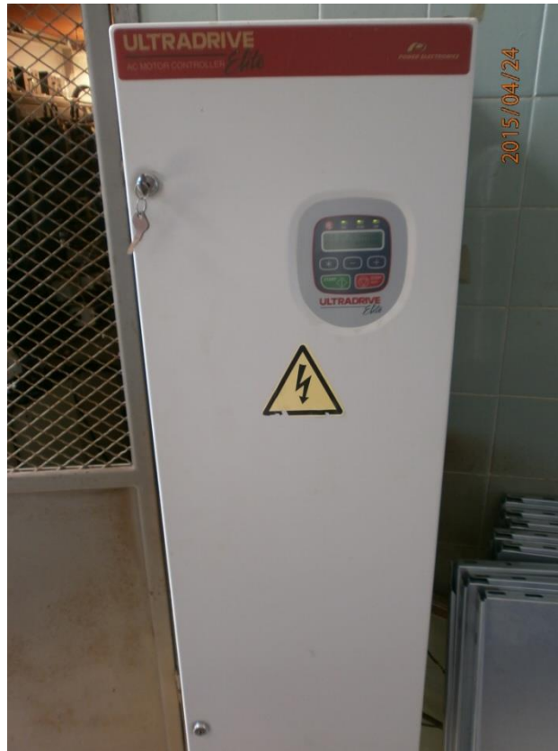
Fotografía 20. Variador de frecuencia instalado en pozo que bombea a depósito
