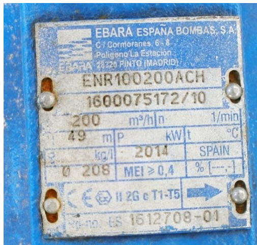
Fotografía 3. Placa datos nominales bomba EBARA
