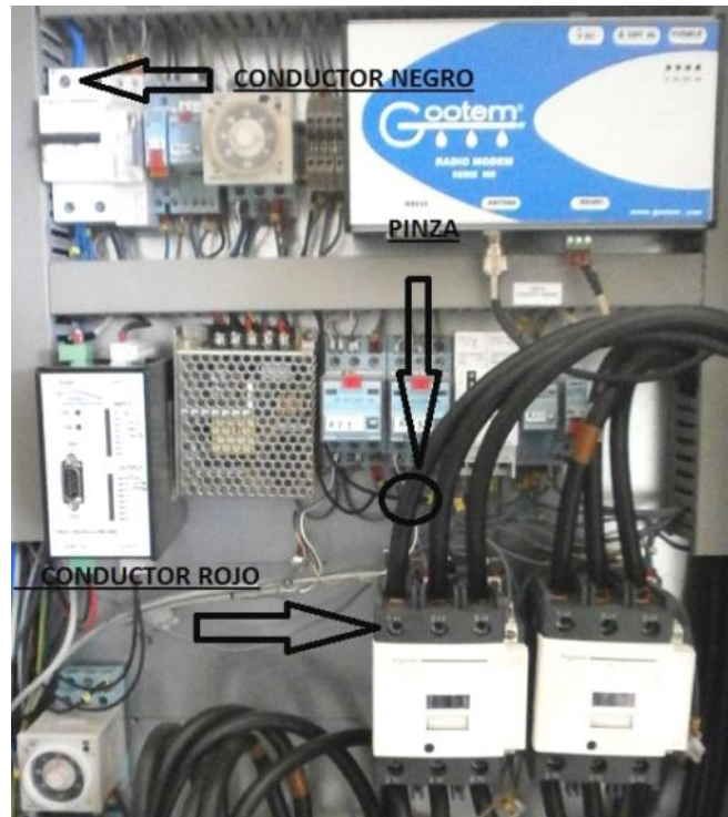
Fotografía 3. Conexión medición Factor de Potencia
