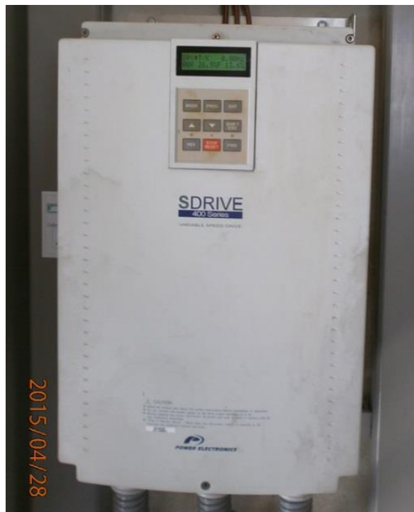
Fotografía 19. Variador de frecuencia instalado en rebombeo directo a red
