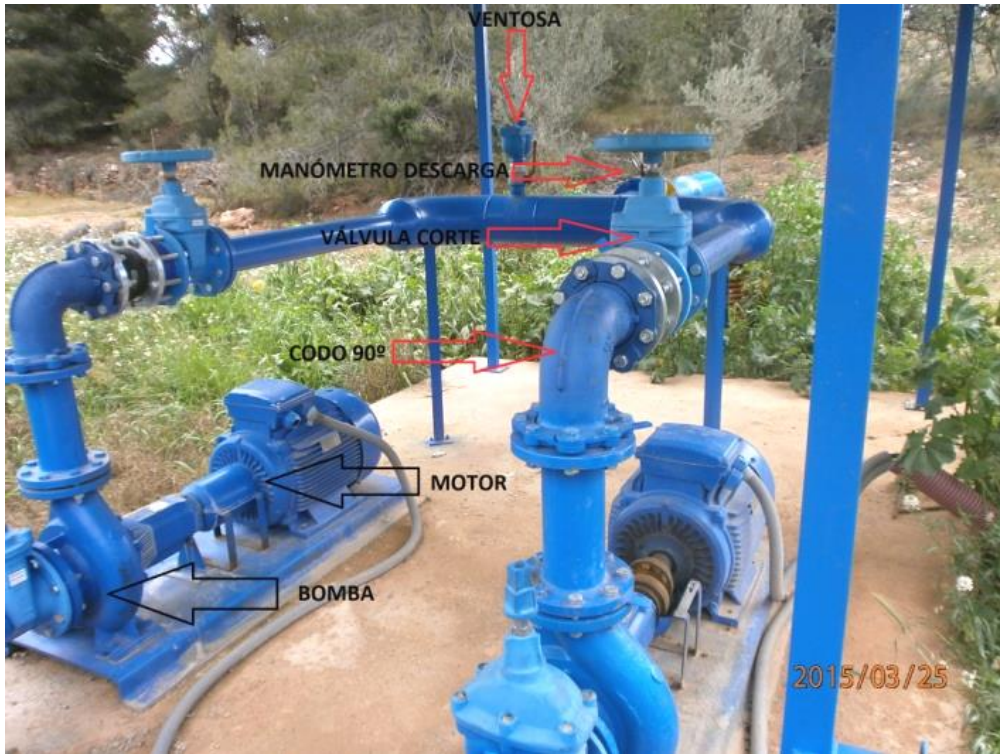
Fotografía 15. Rebompeo y accesorios hidráulicos
