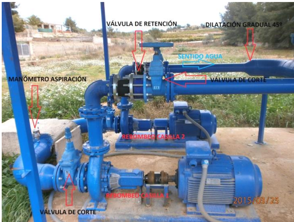
Fotografía 16. Rebompeo y accesorios hidráulicos
