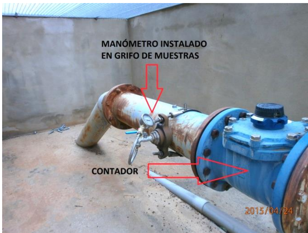
Fotografía 13. Manómetro instalado en grifo de muestras
