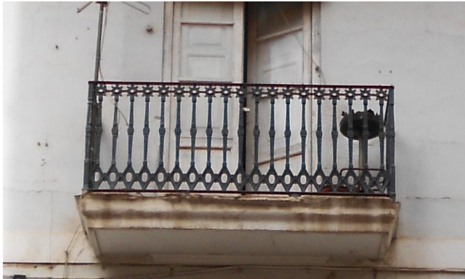
Ilustración 25. Pérdida de sección en moldura de balcones. 2015. Fuente: Elaboración propia
