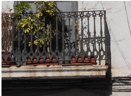
Ilustración 24. Oxidación de barandillas. 2015. Fuente: Elaboración propia
