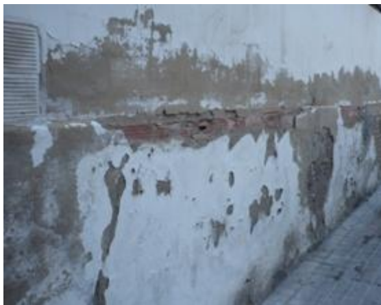
Ilustración 49. Humedad por capilaridad fachada calle Lleida nº 29. Abril 2015.
