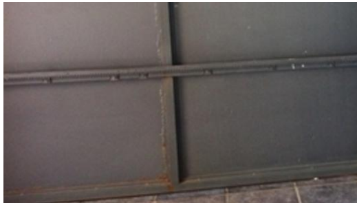
Ilustración 67 Corrosión por aireación diferencial. Abril 2015. Fuente: Internet (Google: corrosión por aireación diferencial)
