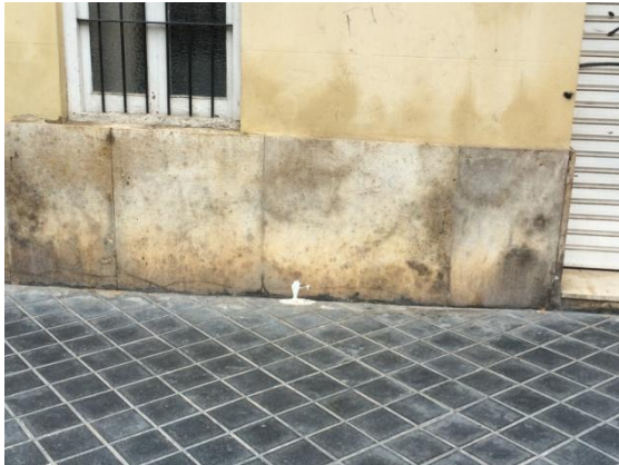
Ilustración 50. Humedad por capilaridad fachada Avenida Constitución nº 4.
