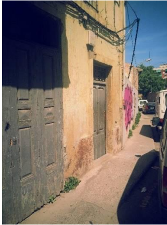
Ilustración 70. Vegetación en el arranque de la fachada.
