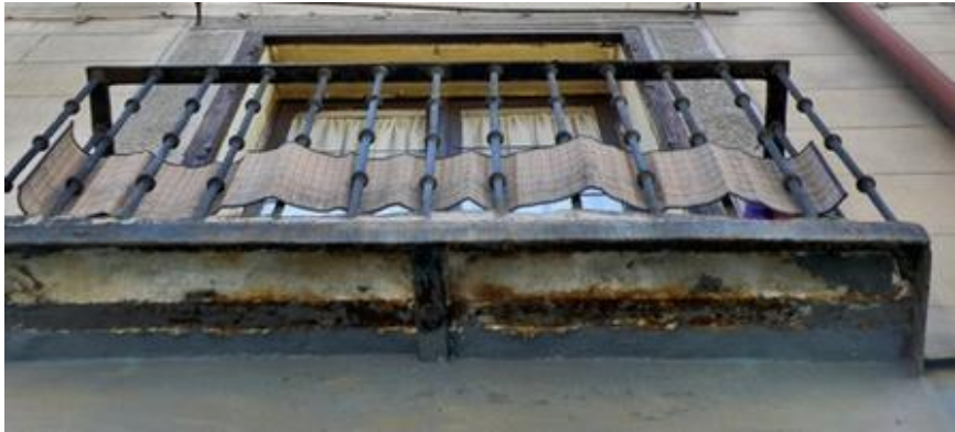
Ilustración 52. Humedad por filtración fachada Calle Lleida nº 17
