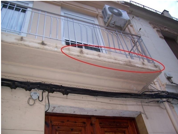
Ilustración 60. Fisura en balcón.
