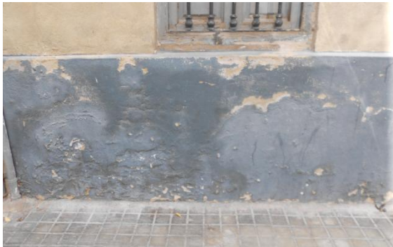
Ilustración 21.Desprendimiento de pintura.2015. Fuente: Elaboración propia
