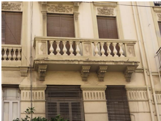
Ilustración 41. Balcón revestido con un punto de desagüe en edificio de estudio. Abril 2015.
