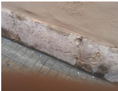
Ilustración 72. Erosión del zócalo del edificio.
