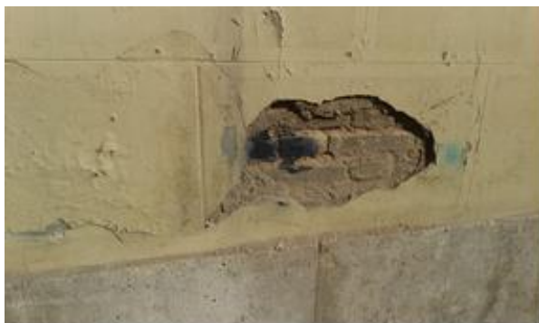
Ilustración 62. Desprendimiento acabado continuo.
