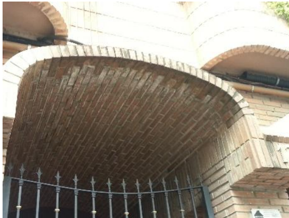
Ilustración 64. Eflorescencia en entrada al patio de la finca.
