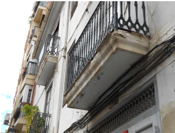
Ilustración 43. Ejemplo de anclaje como elemento impropio en edificio de estudio. Abril 2015.
