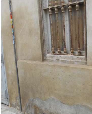
Ilustración 23. Oxidación de rejas. 2015. Fuente: Elaboración propia
