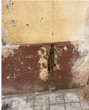
Ilustración 65. Oxidación de la consiguiente rotura del revestimiento.
