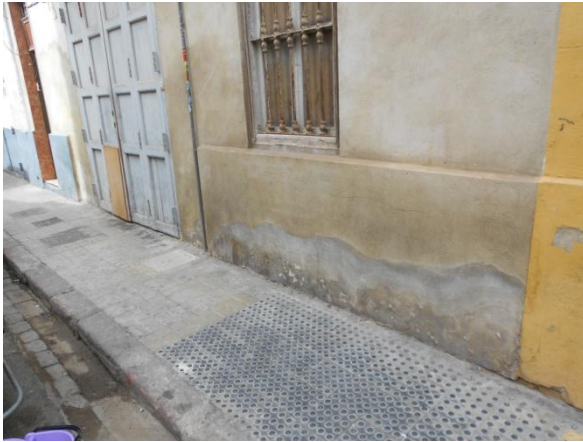
Ilustración 5. Humedad por capilaridad. 2015.
