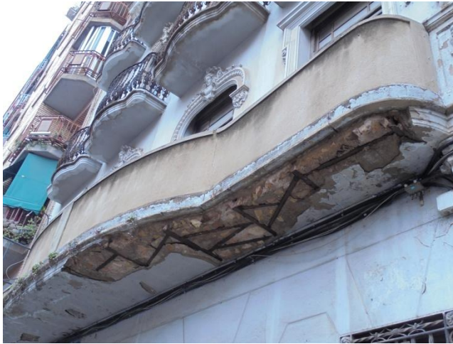
Ilustración 61. Desprendimiento en balcón causado por grietas.
