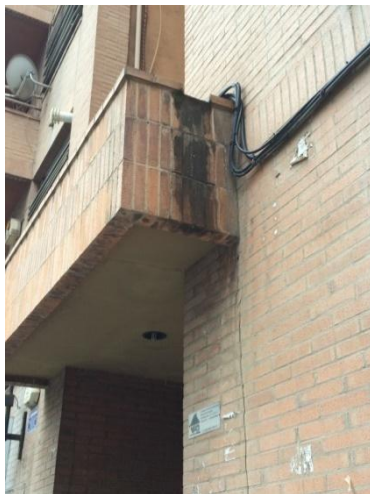
Ilustración 51. Humedad accidental fachada Calle Lleida nº 39
