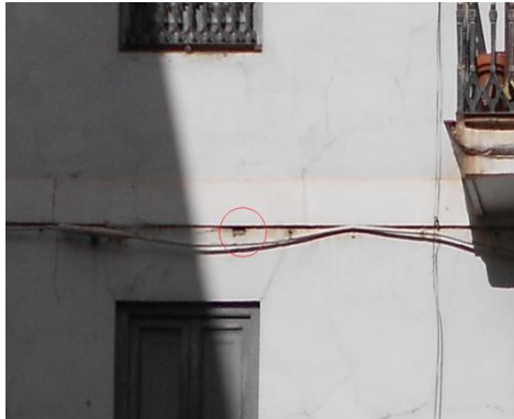
Ilustración 20. Desconchado de revestimiento. 2015.
