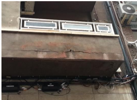
Ilustración 66. Oxidación pieza desagüe provocando una fisura.
