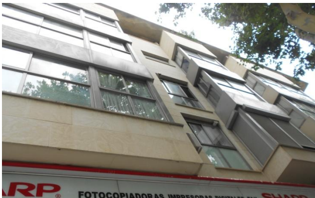
Ilustración 38. Partes de encuentro de la fachada con la carpintería en edificio de estudio.
