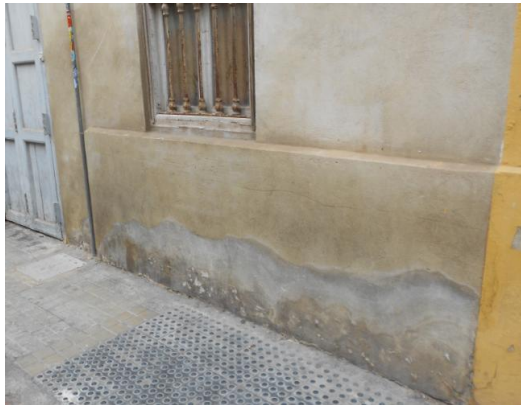
Ilustración 28. Humedad por capilaridad. 2015. Fuente: Elaboración propia
