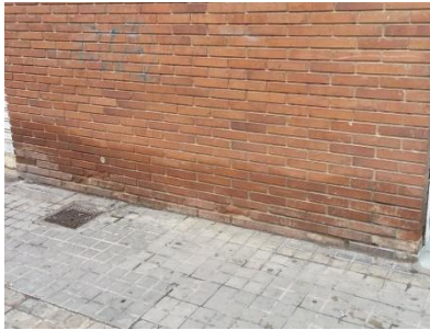
Ilustración 71. Erosión parte baja de ladrillo cara vista.
