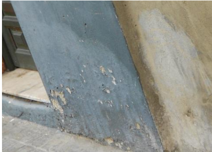
Ilustración 19. Abombamiento de pintura. 2015.
