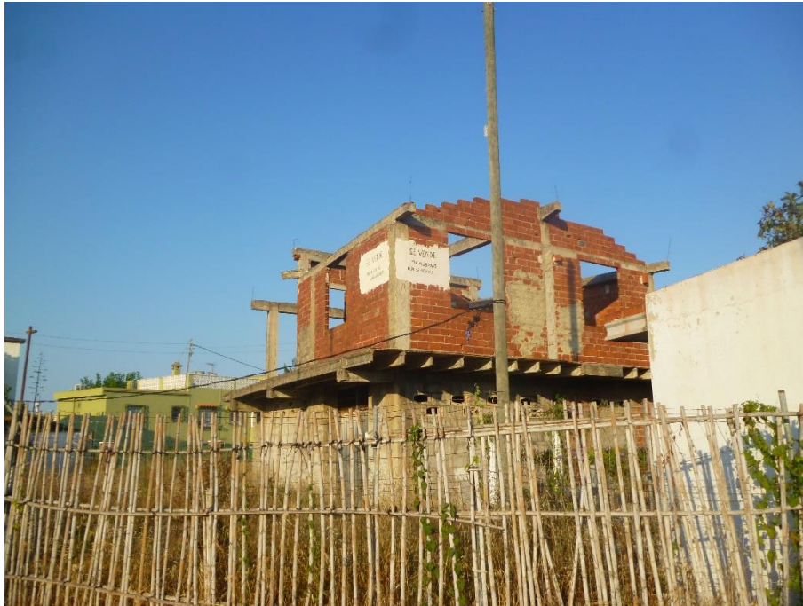
Figura 33. Edificio en construcción abandonado con el techo hundido o sin construir. Fuente propia.
