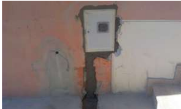
FOTO.116- Instalación de gas realizada por la compañía suministradora.
