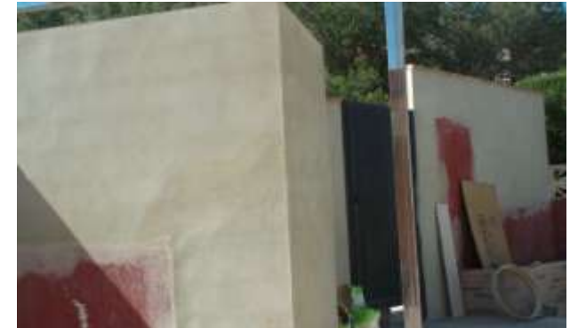
FOTO.99- Enfoscado con mortero y coronación de ladrillo macizo en muro de cerca.
