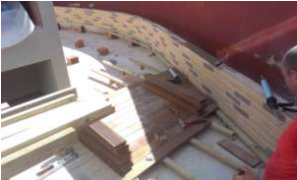
FOTO.121- Pilastras con ladrillo cerámico y tarima flotante de Ipé en terraza exterior.
