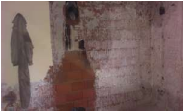
FOTO.43-Picado de paredes en comedor.
