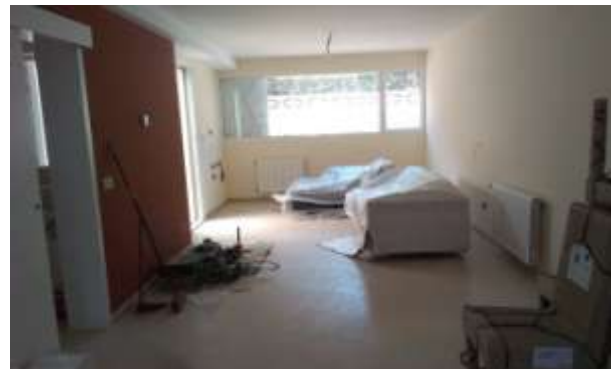
FOTO.131- Instalación de radiadores y revestimiento de la última capa de acabado del microcemento en comedor.
