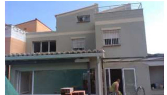
FOTO.114-Revestimientos con pintura de las rejas de las ventanas en la fachada Norte.
