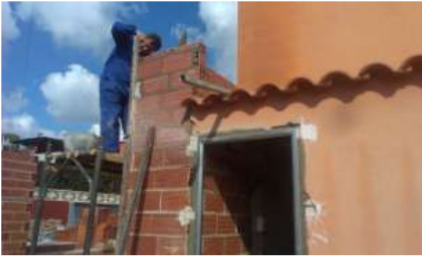
FOTO.55-Apertura de hueco en cuarto de calderas, colocación de puerta de acero galvanizado y coronación de paellero.
