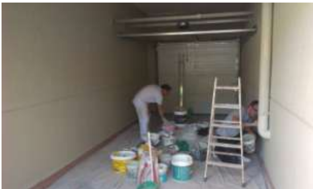
FOTO.124- Revestimientos con pintura en aparcamiento.
