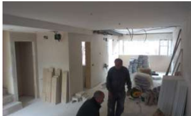
FOTO.62-Enlucidos de yeso en comedor y armario P.B.
