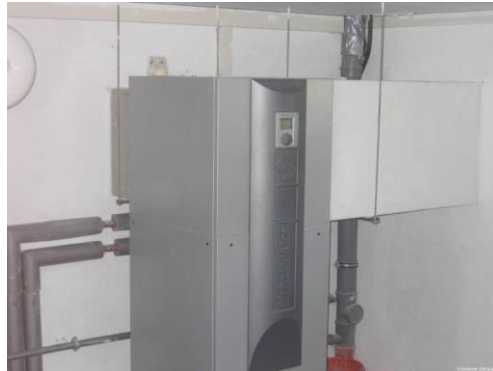
Foto 2.1: Bomba de calor geotérmica instalada en un edificio para su climatización. (Fuente: Fundación energía Comunidad de Madrid)
