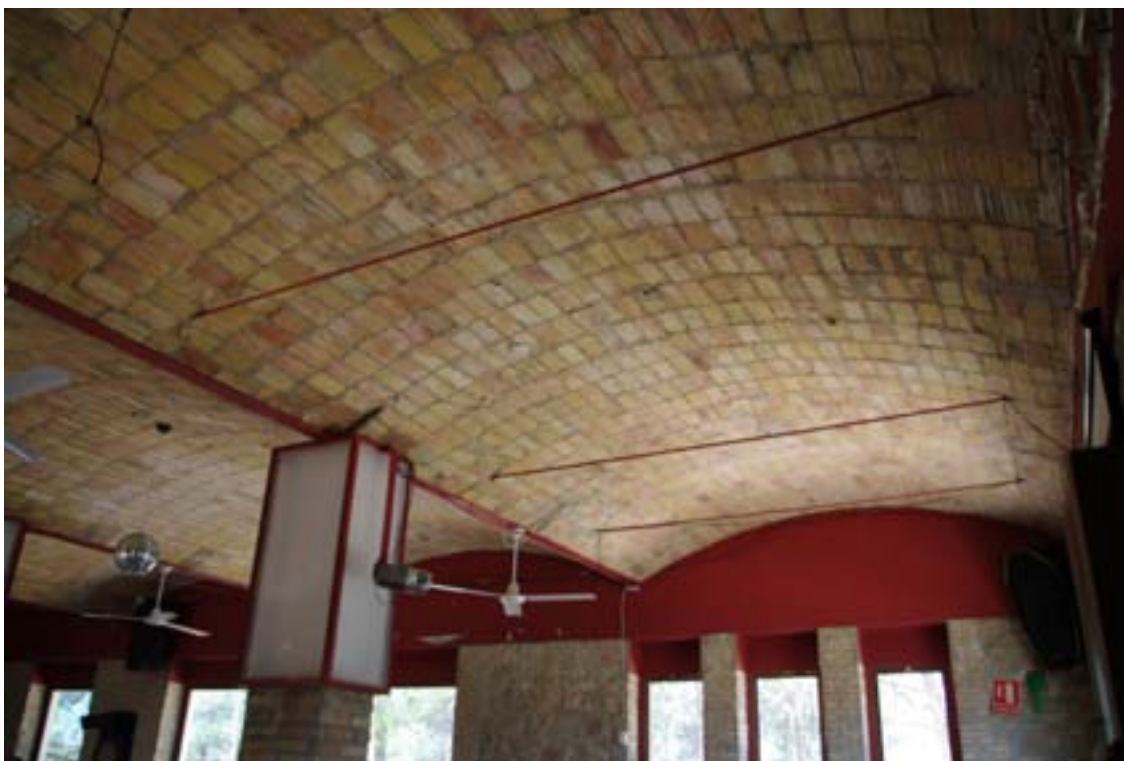
Vista interior de las bóvedas tabicadas en la formación de la azotea. Fotografía de la autora.
