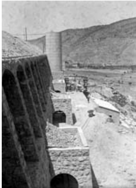
Plataforma de suministro y dosificación de áridos. Fuente: CHJ.
