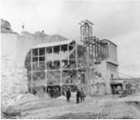
Estaciones de arena (primer plano) y grava (fondo). Fuente: CHJ
