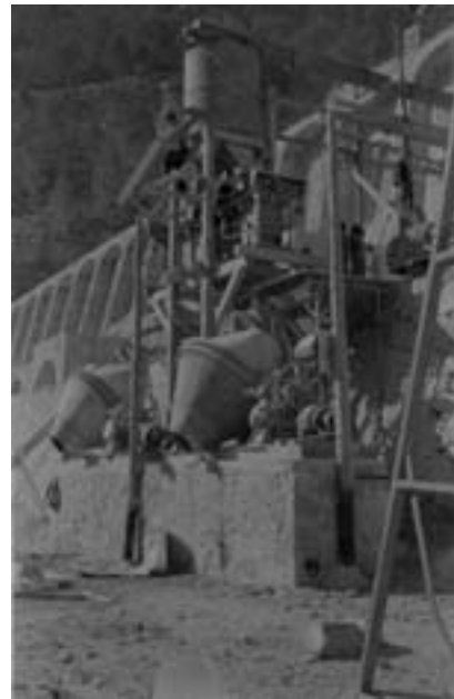
Dosificador de cemento y hormigoneras. Fuente: CHJ.
