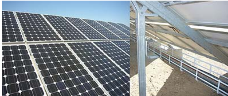
Fig. 2. 7. Detalle de cableado sobre rejilla en Instalación Fotovoltaica
