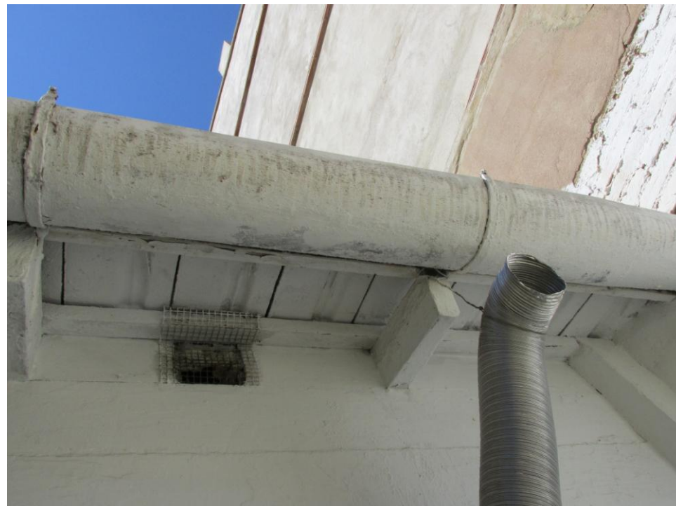
Fotos 23. Detalle canalón y respiraderos
