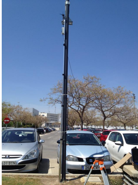
Figura 3.1.2.6: Antena de radio y transmisor
