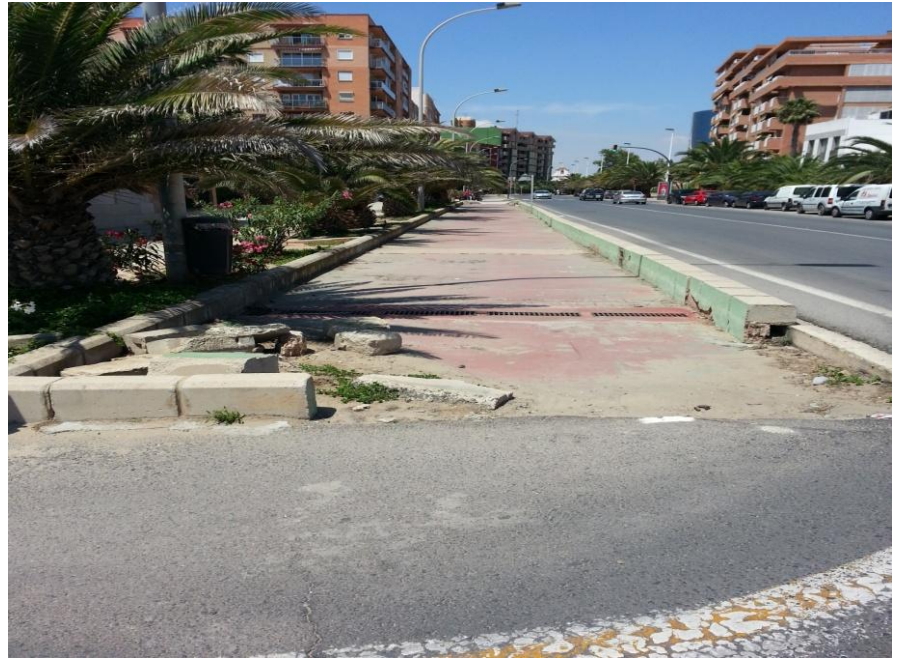
Imagen 2. Mal estado del carril e invasión de la vegetación
