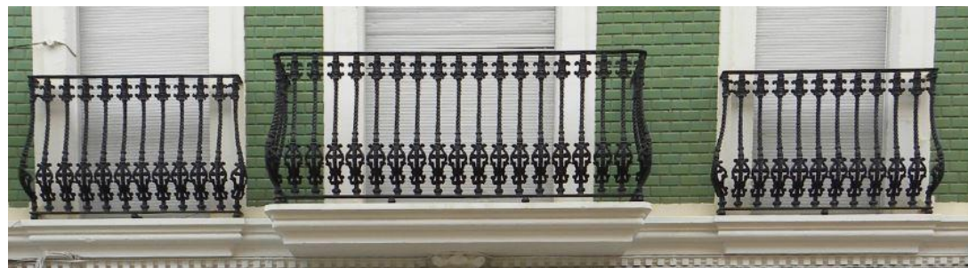
Ilustración 30. Cerrajería en barandilla
